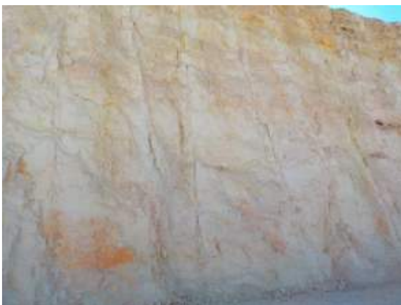
Ilustración 14. La calidad geomecánica SMR del talud es de 55. Se prevén roturas superficiales en la cara libre del talud, según cuñas o bloques descalzados por el talud de banco, que originaría caídas locales.
