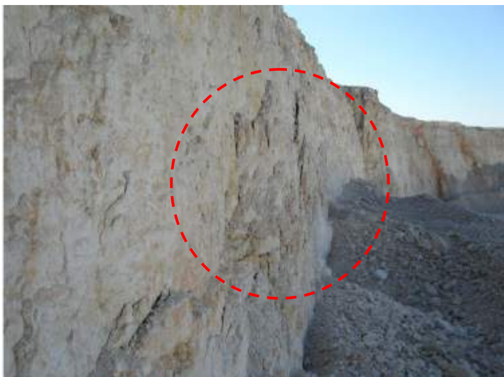
Ilustración 17. Diaclasado subparalelo al talud en talud Este (Fuente: Informe geotécnico).
