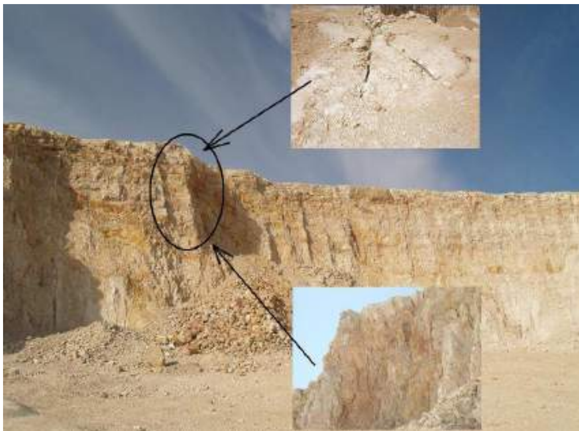
Ilustración 16. Cuñas de roca en parte alta del talud (Fuente: Informe geotécnico).
