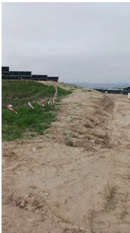
Imagen 11. Afección 1 presencia de zanja.
