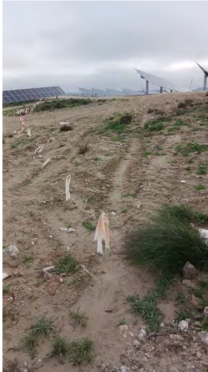
Imagen 15. Afección 5, presencia de zanja.
