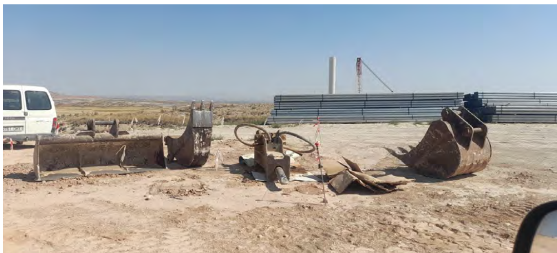
Foto 15: maquinaria balizada sobre suelo desnudo.
