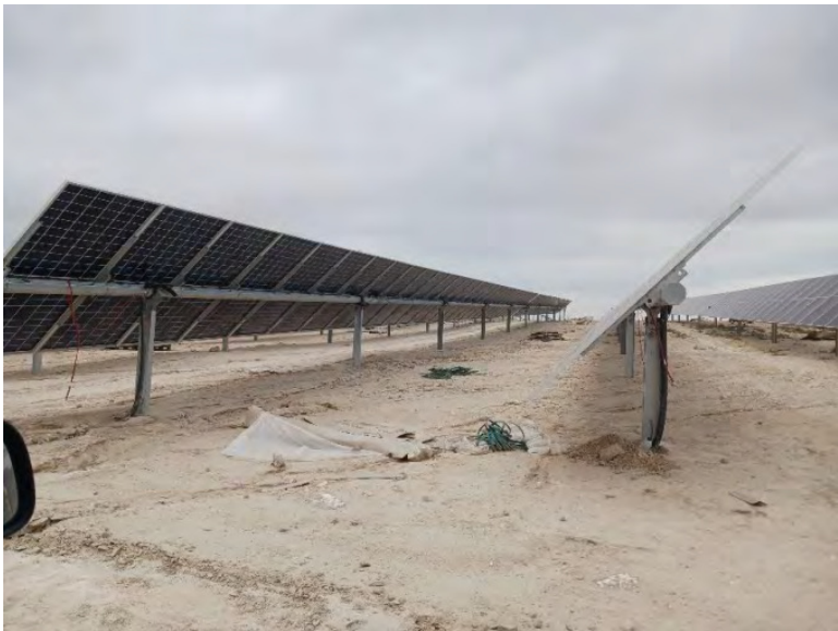
Figuras 2, 3 y 4: Residuos dispersos a la intemperie en varias zonas de la obra.
