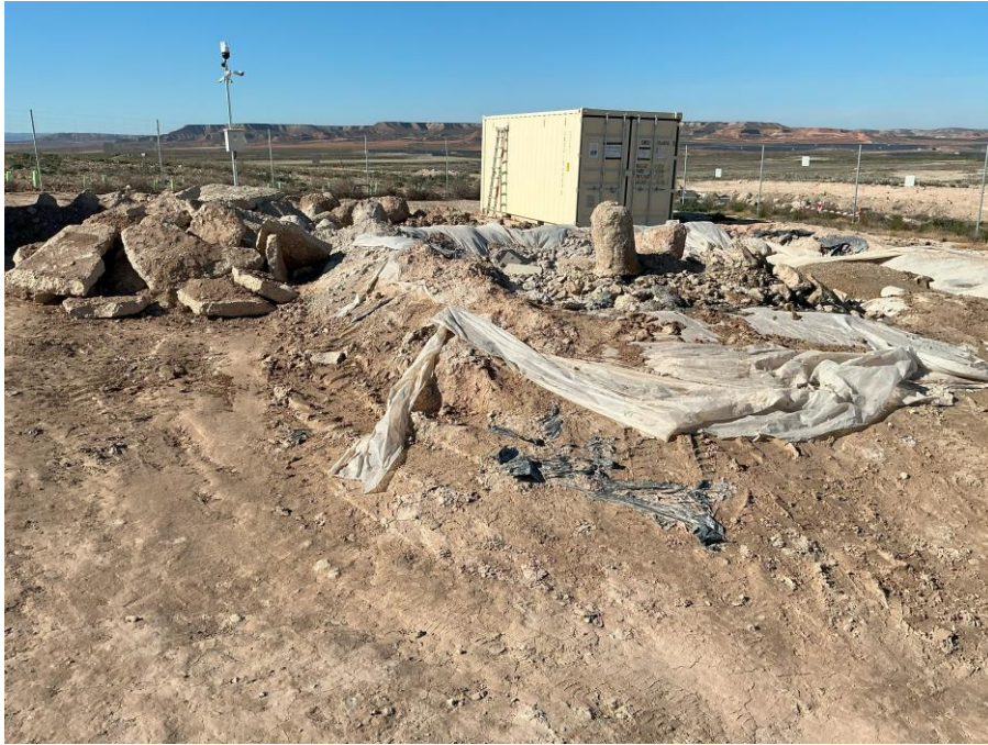
Foto 1: estado deficiente de la balsa de hormigón.
