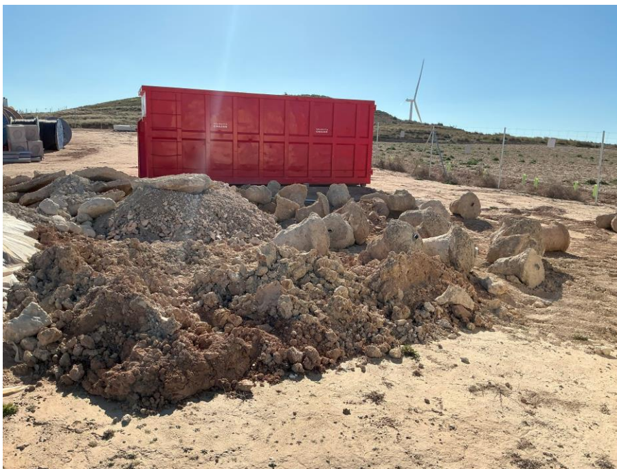
Foto 5: parte trasera de la balsa de hormigón con residuos fuera de la misma.
