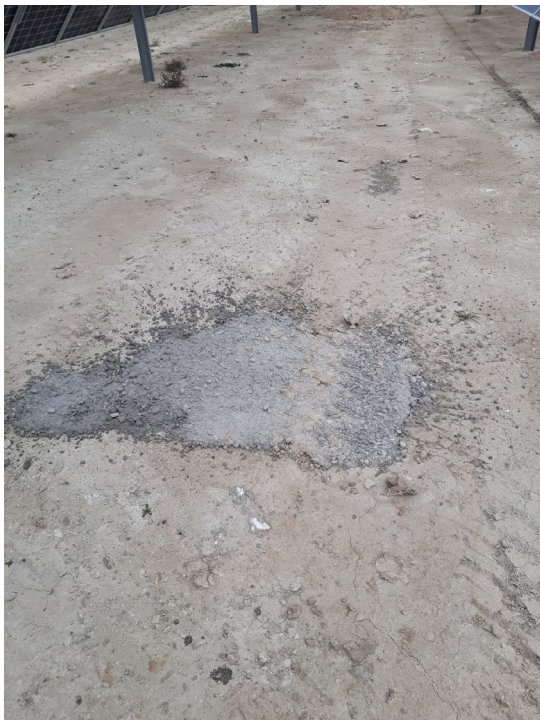
Foto 2: derrame de hormigón entre trackers.
