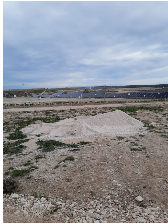
Foto 5: restos de zahorra acopiados indebidamente.
