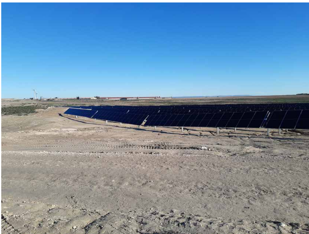
Foto 6: Zonas altamente compactadas. Se solicita su des compactación.
