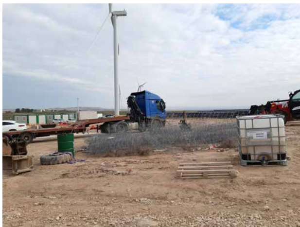
Foto 4: se solicita mayor orden y limpieza en zona de acopios.
