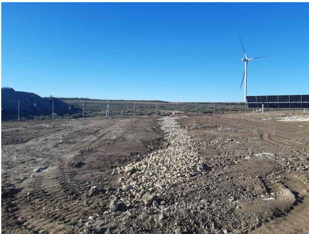
Foto 6: Relleno de cárcavas con canto rodado. Se solicita el extendido de tierra sobre los mismos para favorecer el crecimiento de vegetación.
