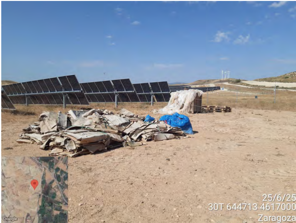
Imagen 5: Acopio de residuos.
