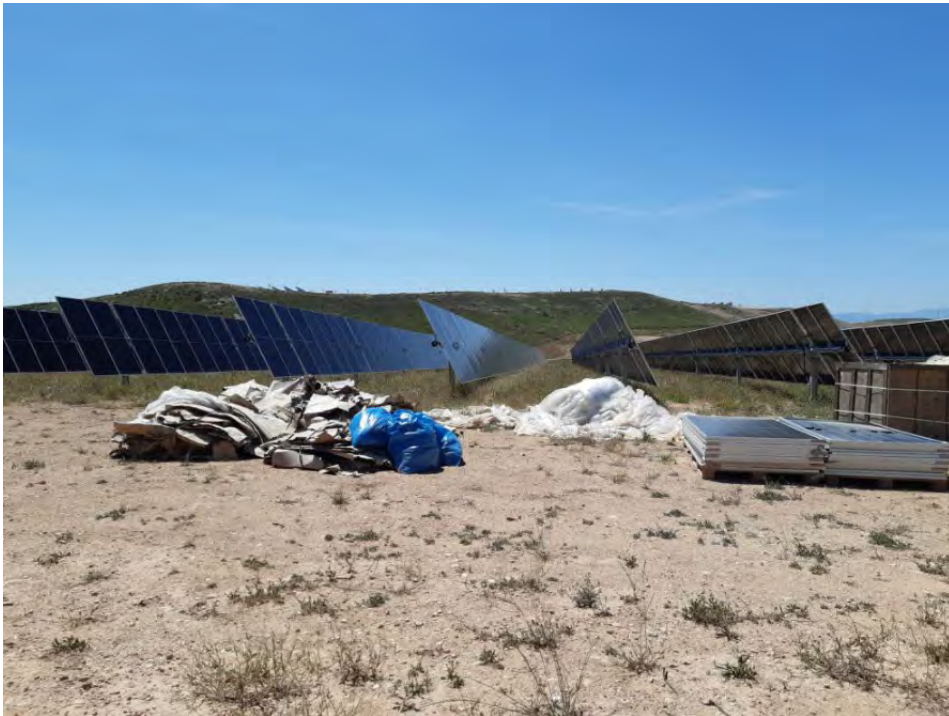
Imagen 5: Acopio de residuos.
