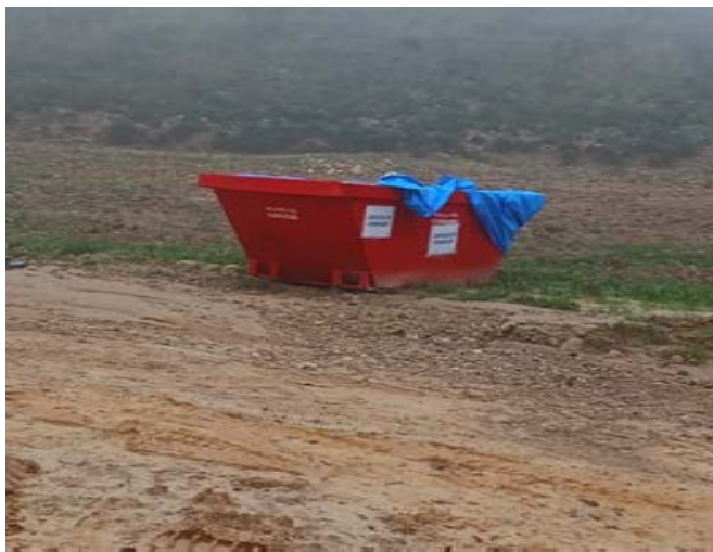
Figura 1. Contenedor de cemento en correcto uso.
