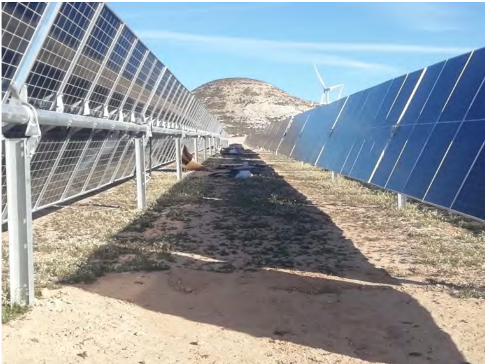
Imagen 2: Residuos en la obra.
