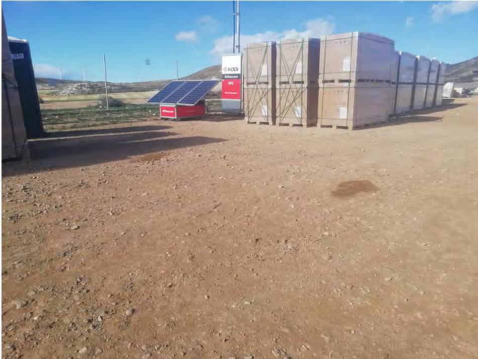
Imagen 1: Manchas de líquido contaminante.
