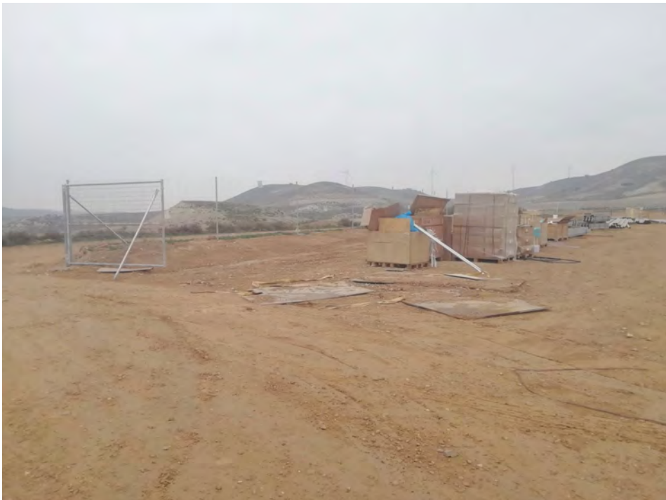
Imagen 2: Residuos en la obra.
