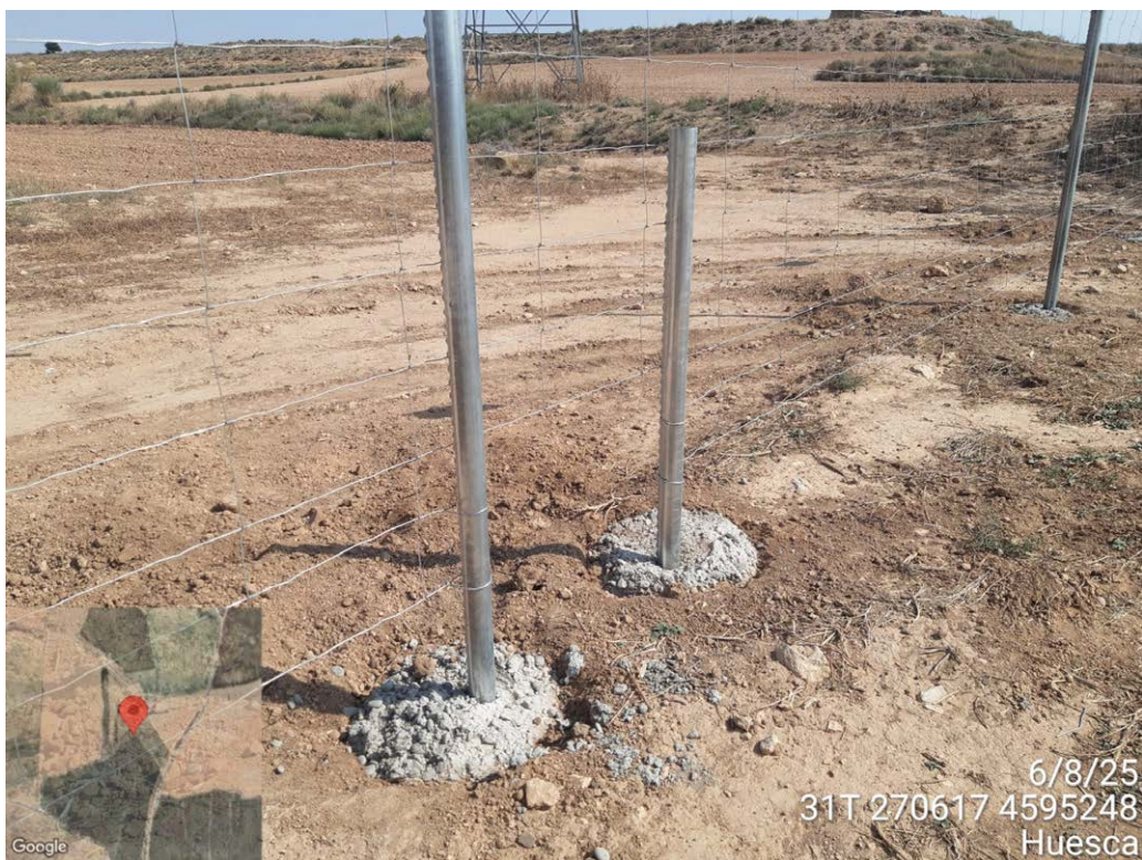
Imagen 7: Pasos de fauna en vallado perimetral.
