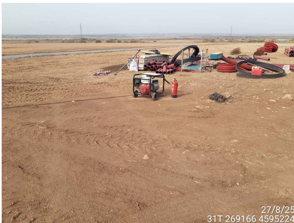
Imagen 6: Grupo electrógeno sin protección del suelo.
