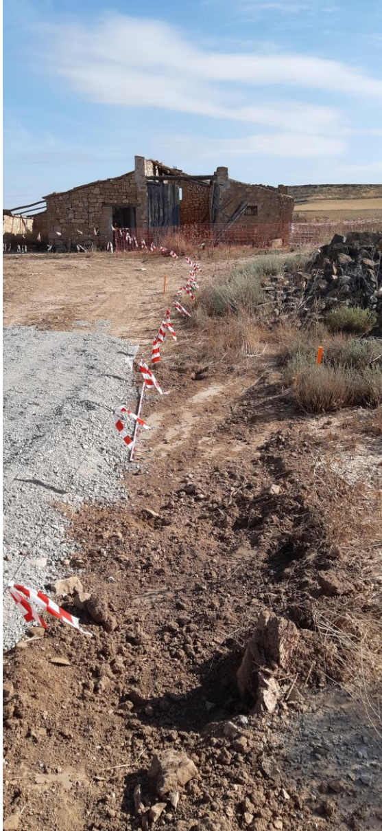
Fig. 4: Después de la afección.
