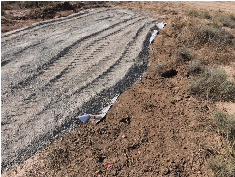
Imagen 11: Afección a camino fosilizado.
