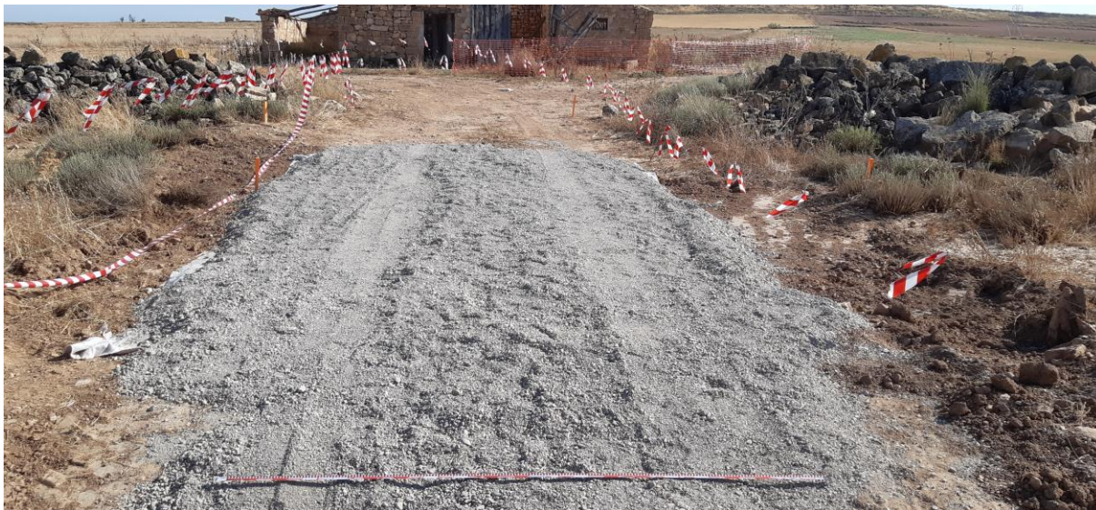
Fig. 5: Después de la afección.
