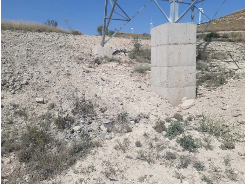
Imagen 7: Residuos de hormigón en LAAT tras la restauración.
