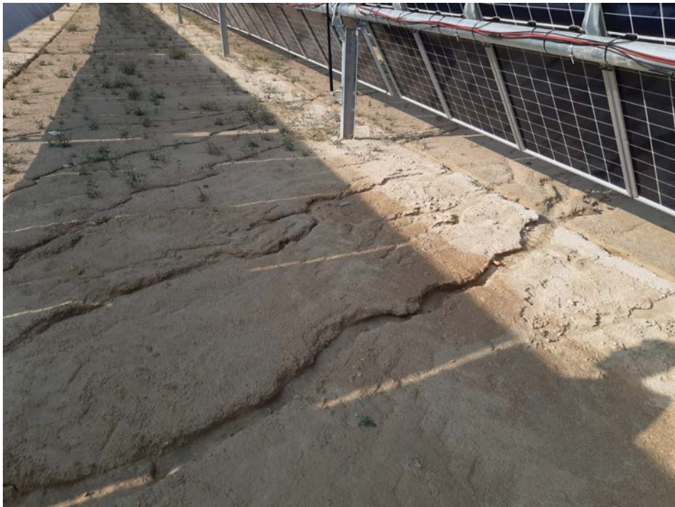
Imagen 2: Zona con erosión.
