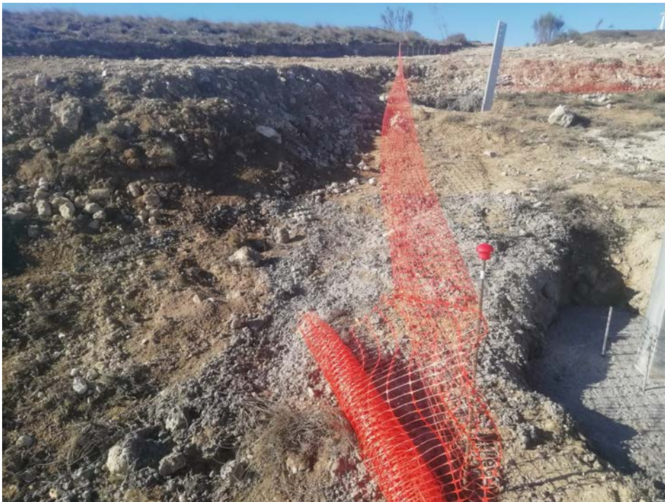
Imagen 6: Residuos de hormigón en LAAT (anterior a restauración).
