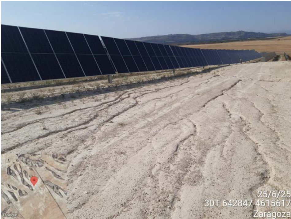
Imagen 1: Zona con erosión.
