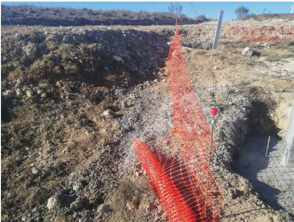
Imagen 7: Residuos de hormigón en LAAT.
