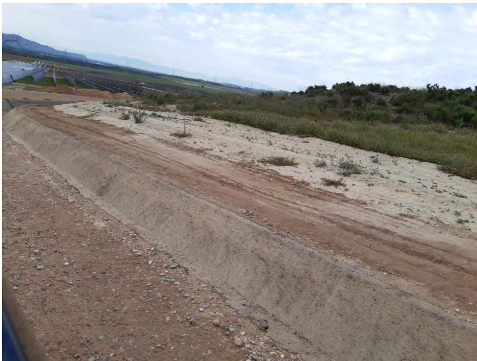
Imagen 3: Cuneta para el drenaje de la planta.
