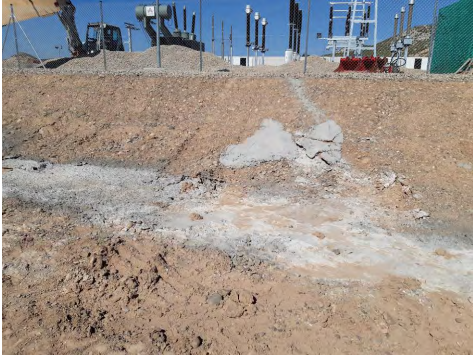
Imagen 6: Residuos de hormigón.
