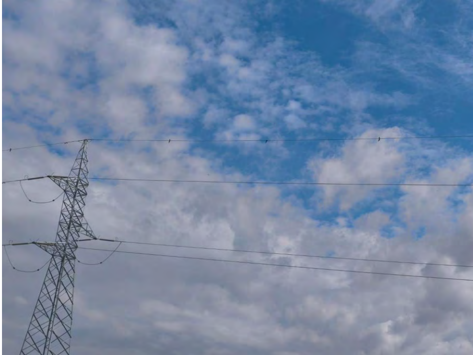
Imagen 10: Balizas salvapájaros en LAAT.
