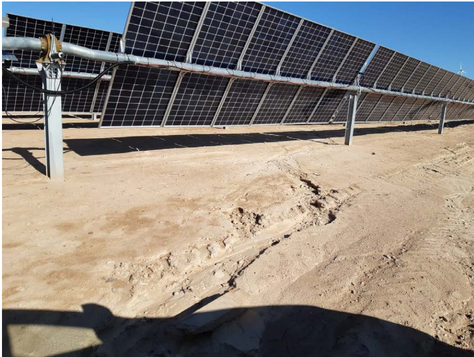
Imagen 1: Zona con erosión.
