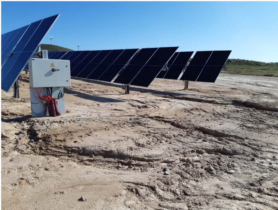
Imagen 2: Zona con erosión.
