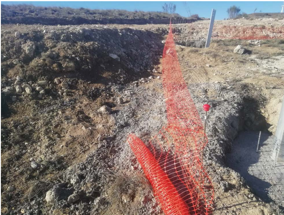
Imagen 6: Residuos de hormigón en LAAT.
