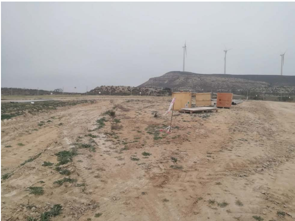
Imagen 12: Materiales acopiados encima de acopio de tierra vegetal.
