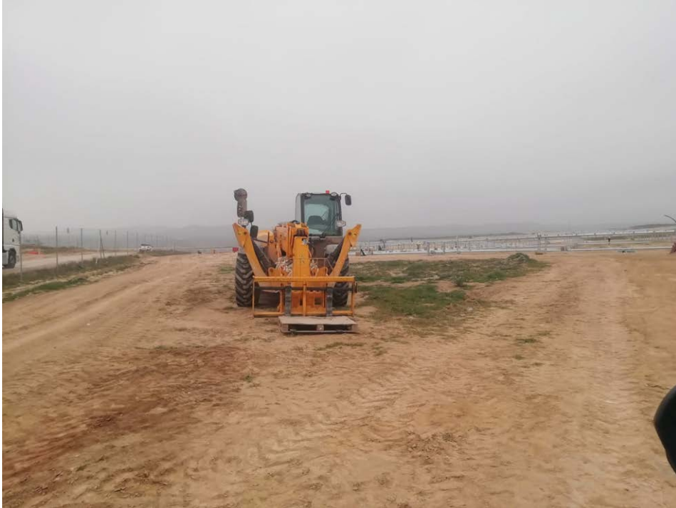
Imagen 13: Maquinaria encima de acopio de tierra vegetal.
