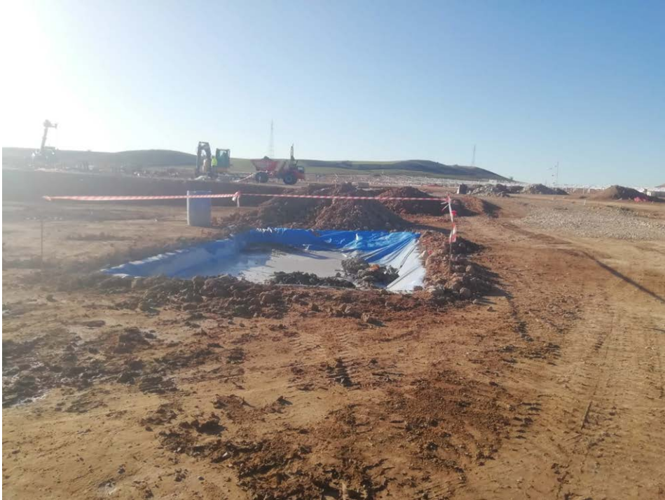
Imagen 3: Balsa para hormigón.
