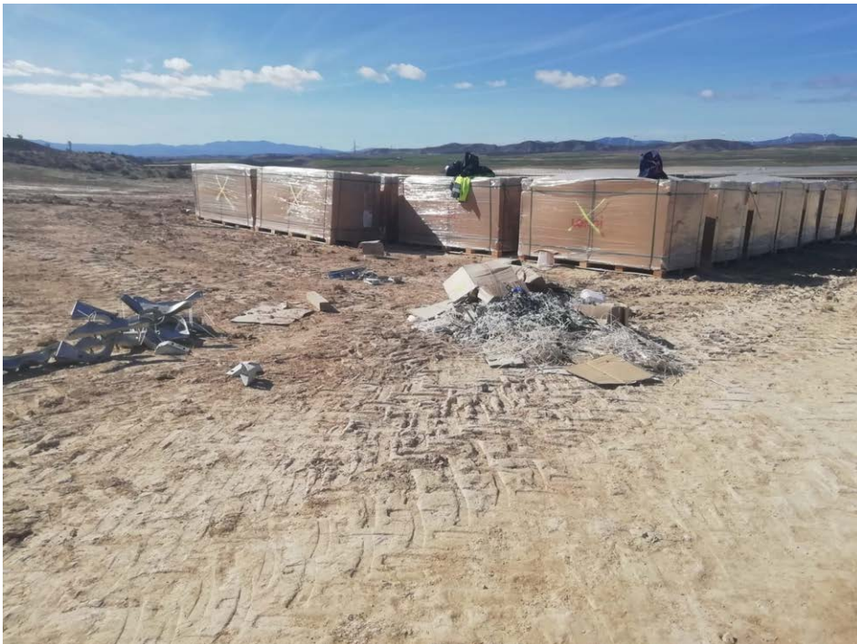
Imagen 2: Residuos acopiados fuera de los contenedores.
