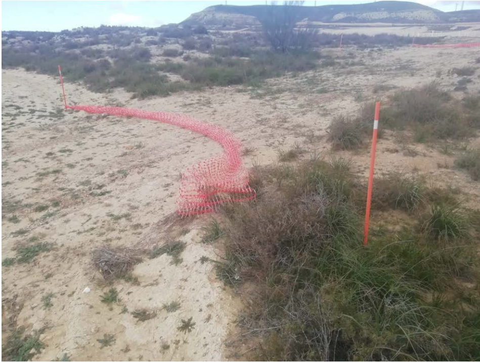
Imagen 5: Balizado mal colocado.
