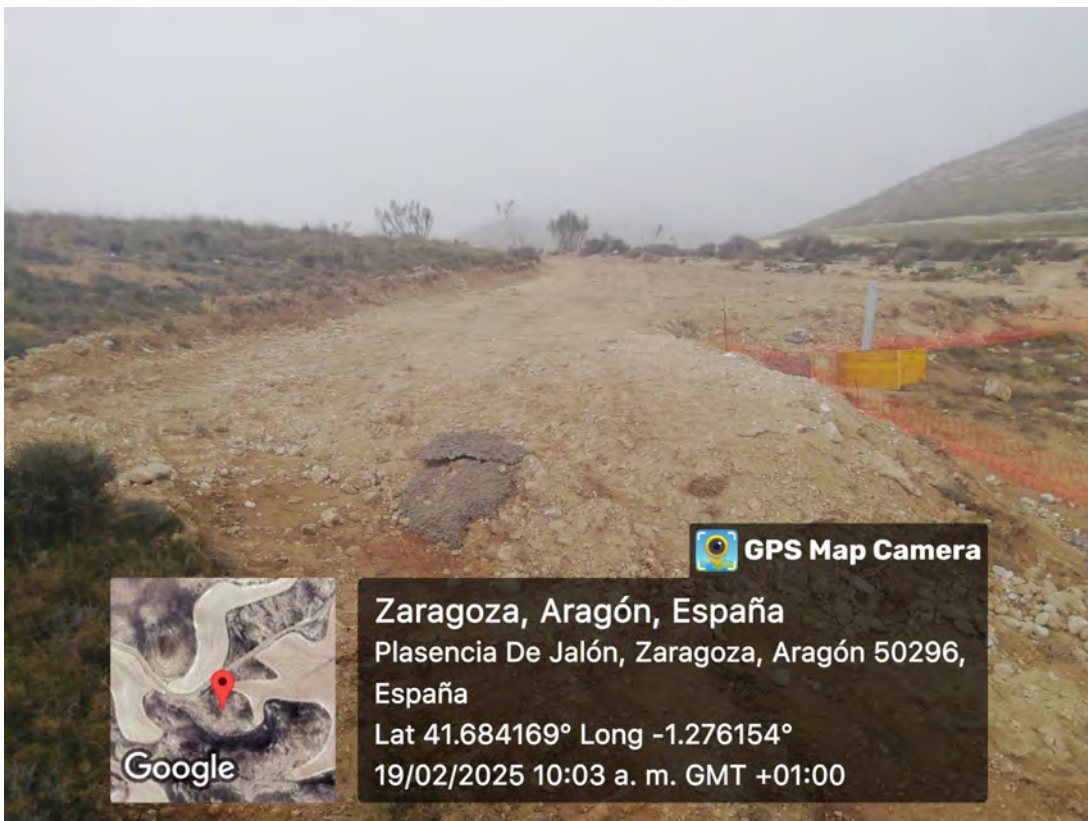
Fig. 2: Zona de HIC afectada por excavación de los apoyos de la LAAT.
