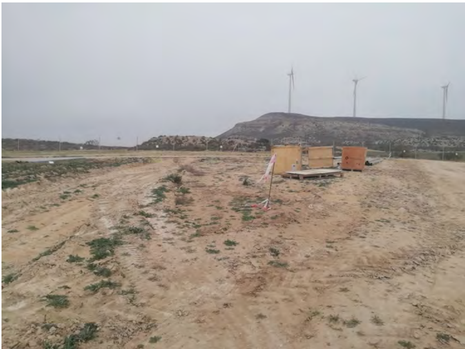
Imagen 16: Materiales acopiados encima de acopio de tierra vegetal.
