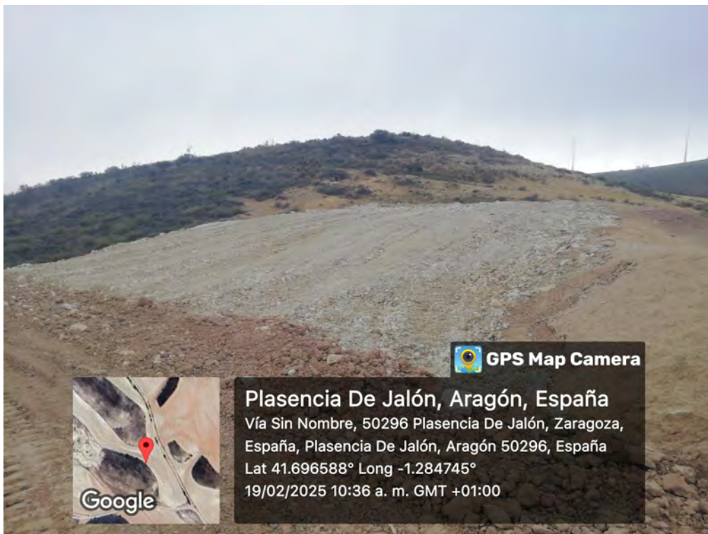
Fig. 8: Zona de HIC afectada por excavación de los apoyos de la LAAT.
