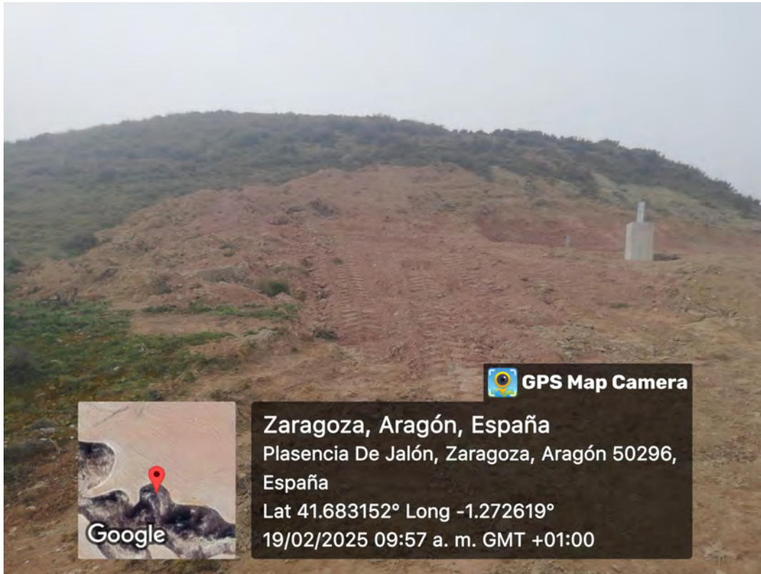
Fig. 1: Zona de HIC afectada por excavación de los apoyos de la LAAT.
