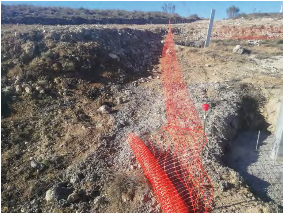
Imagen 4: Residuos de hormigón en LAAT.
