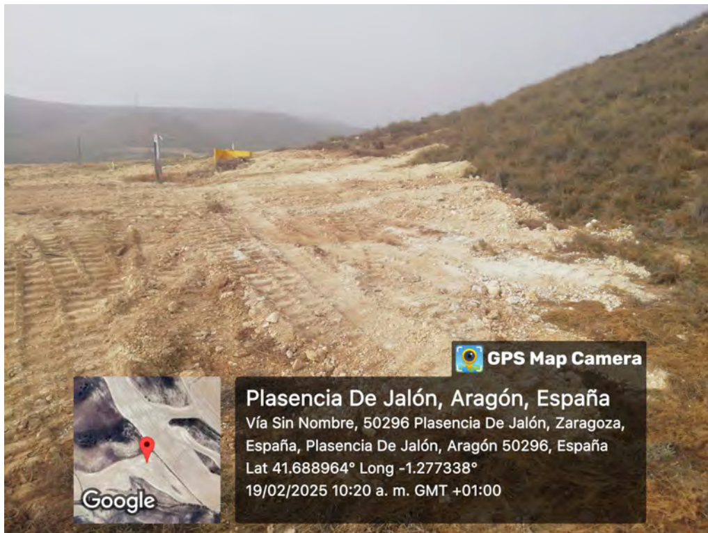
Fig. 4: Zona de HIC afectada por excavación de los apoyos de la LAAT.
