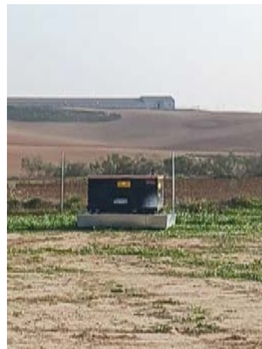
Figura 4. Cubeta de retención en grupo electrógeno
