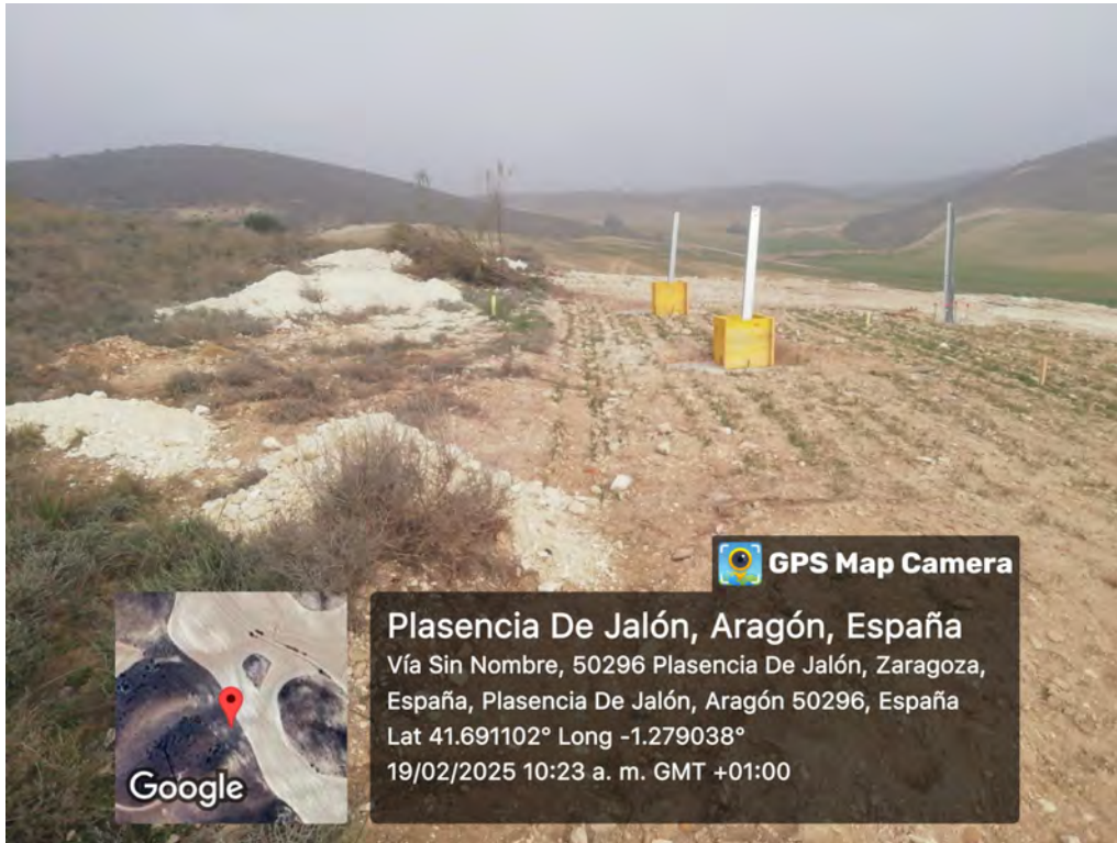
Fig. 5: Zona de HIC afectada por excavación de los apoyos de la LAAT.
