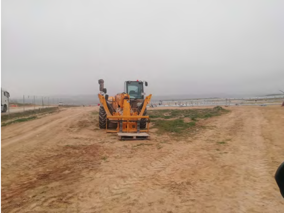
Imagen 13: Maquinaria encima de acopio de tierra vegetal.
