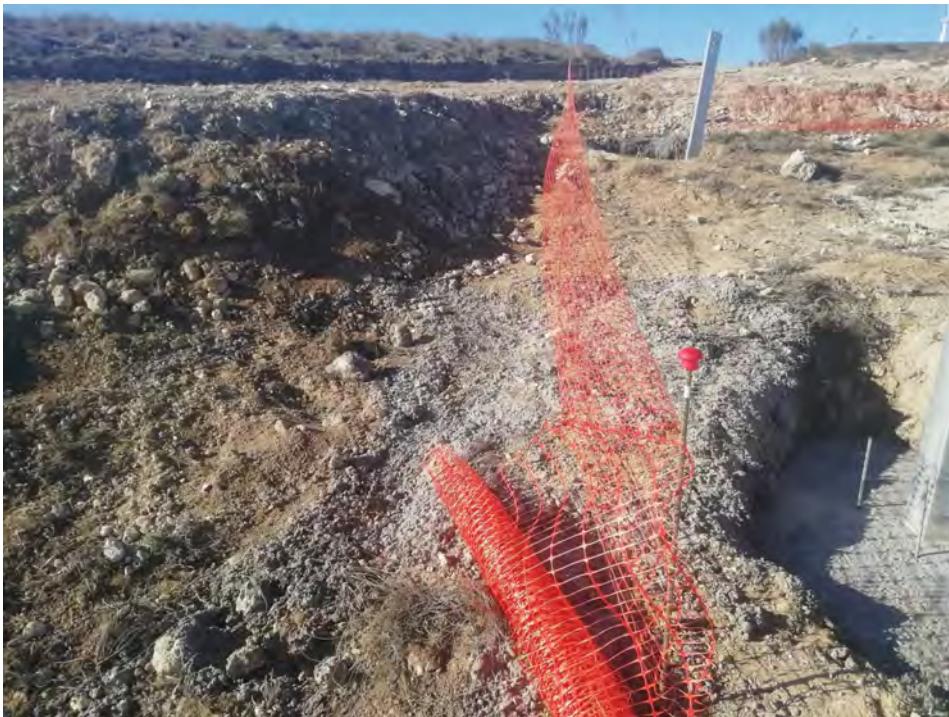
Imagen 4: Residuos de hormigón en LAAT.
