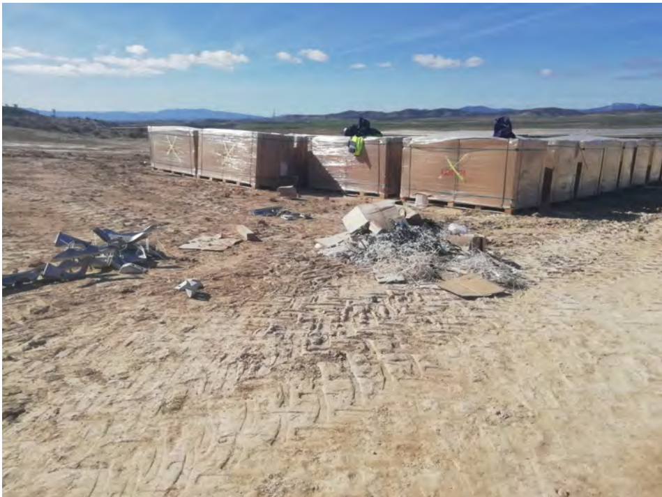
Imagen 2: Residuos acopiados fuera de los contenedores.
