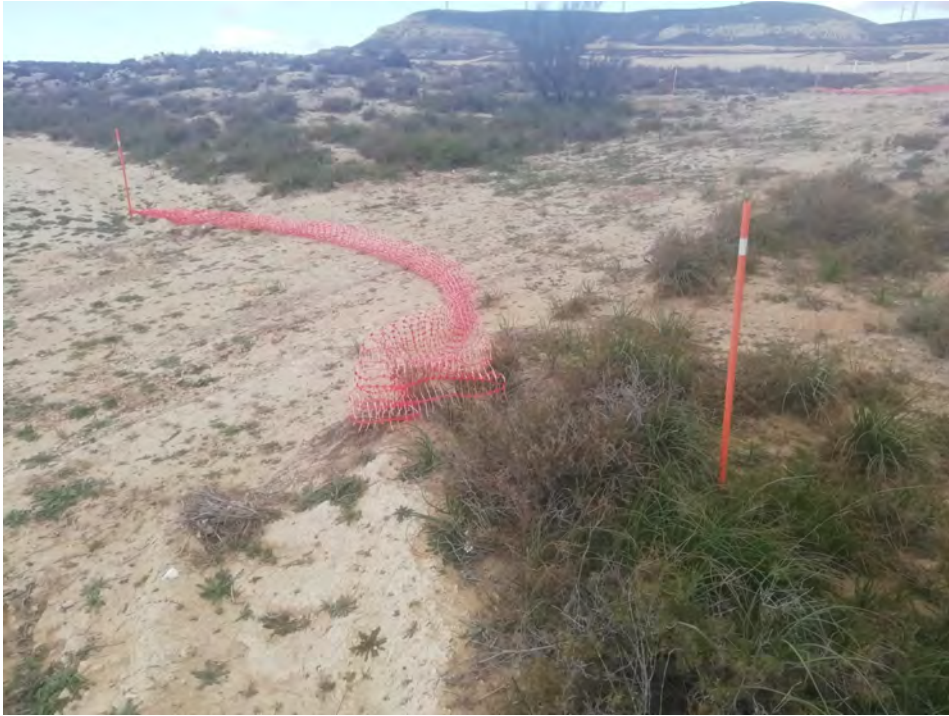
Imagen 5: Balizado mal colocado.
