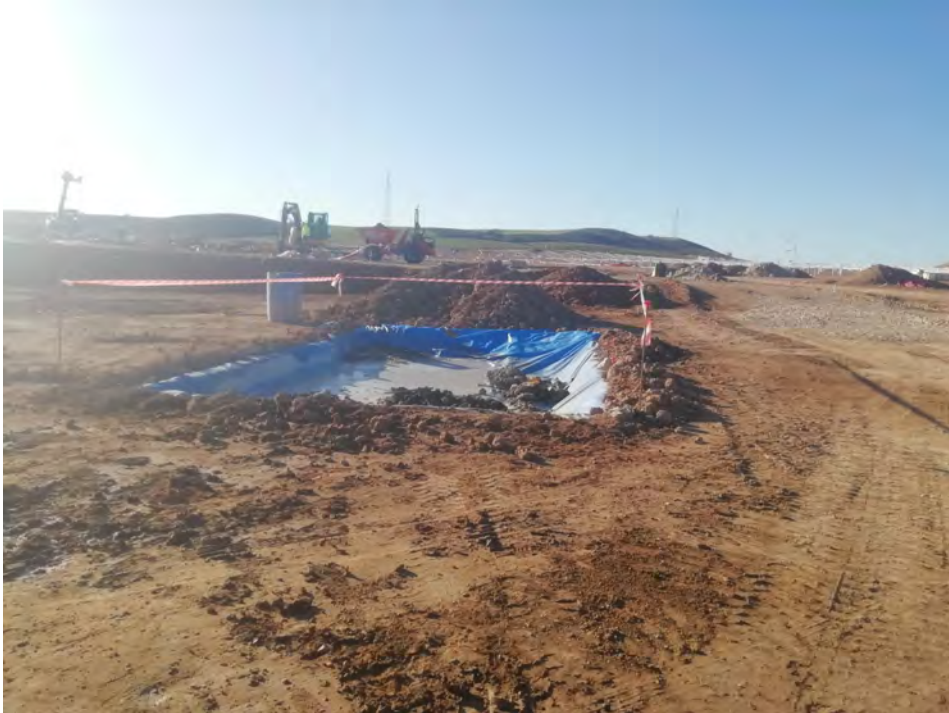
Imagen 3: Balsa para hormigón.
