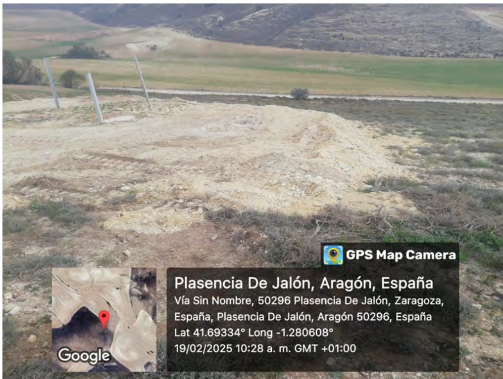
Fig. 6: Zona de HIC afectada por excavación de los apoyos de la LAAT.
