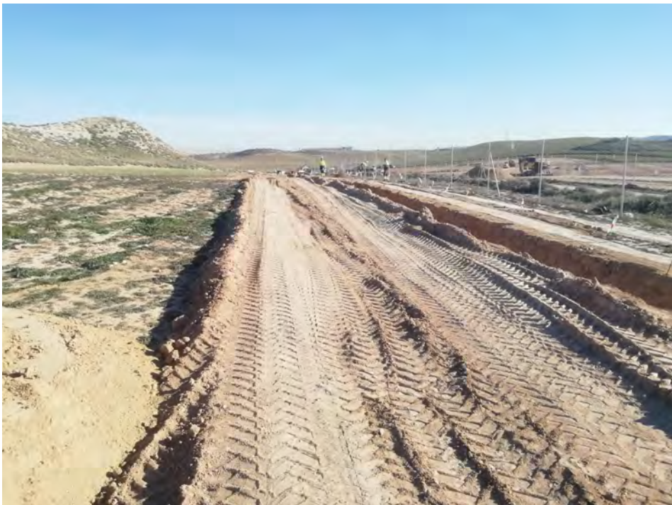
Imagen 10: Tierra vegetal de excavación de zanja pisada por maquinaria.
