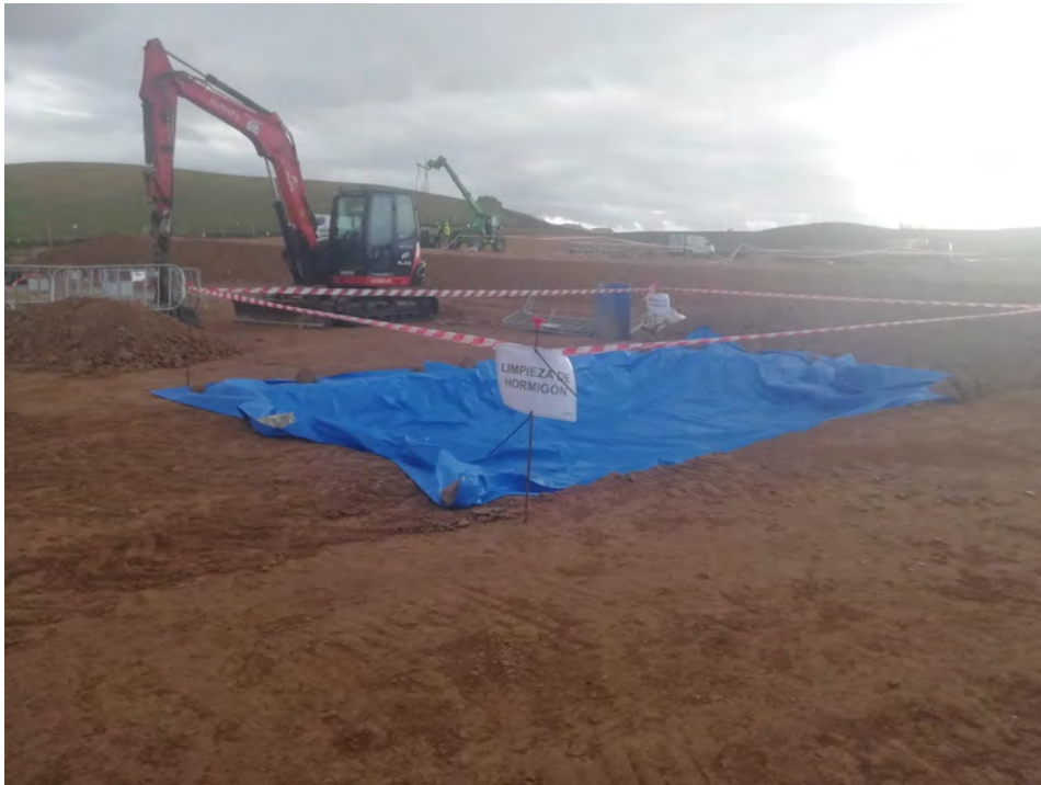
Imagen 5: Balsa para hormigón.
