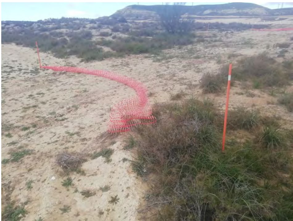
Imagen 6: Balizado mal colocado.
