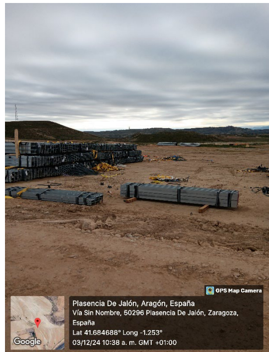
Figura 2 Eslingas y flejes sueltos en zona de trabajo.
