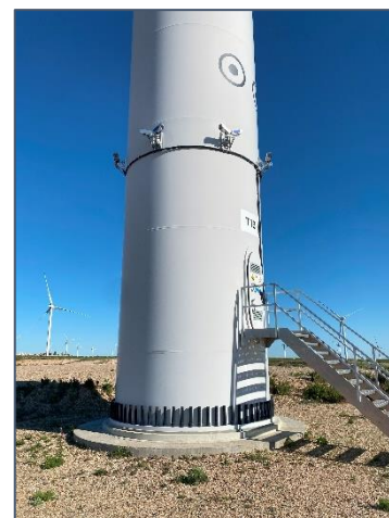
Dispositivo 3DObserver instalado en el aerogenerador T-13
