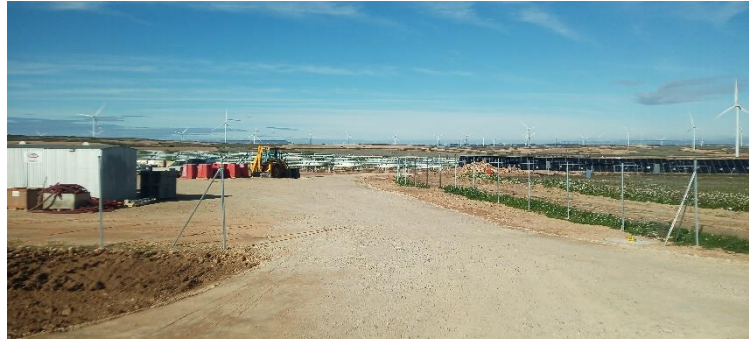
Figura 24: Acceso de entrada a la planta fotovoltaica desde el parque eólico.
