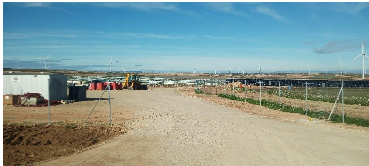
Figura 17: Acceso de entrada a la planta fotovoltaica desde el parque eólico.
