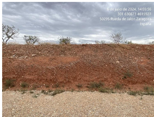
Figura 15: Taluz al Noreste del aerogenerador.
