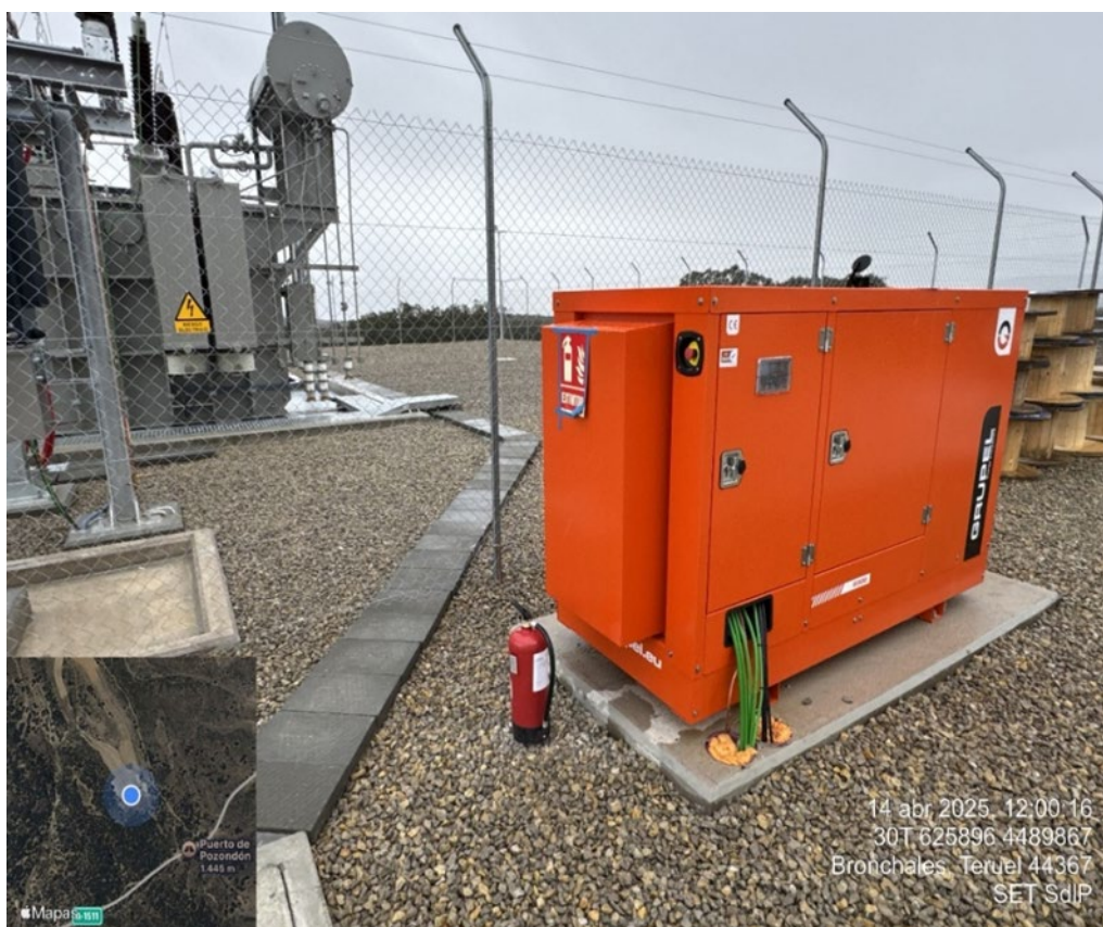
Fotografía 10. Extintor junto a grupo electrógeno
