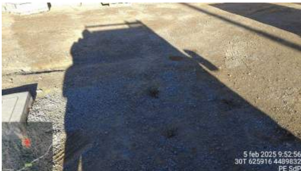
Fotografía 21. Manchas de combustible en la SET asociadas al equipo de inyección (2)
