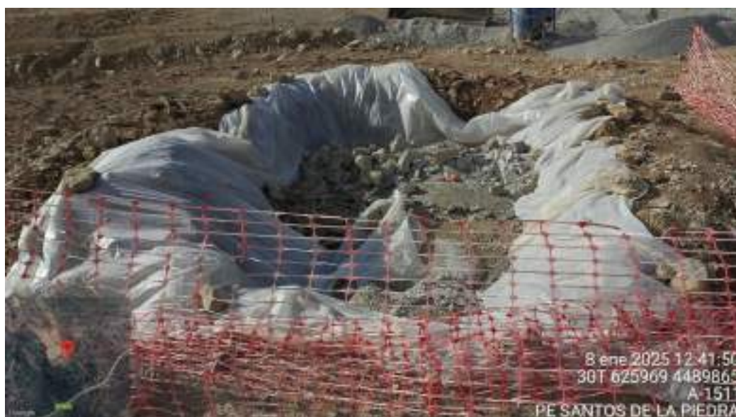
Fotografía 16. Lavadero de cubas de hormigón junto a la SET
