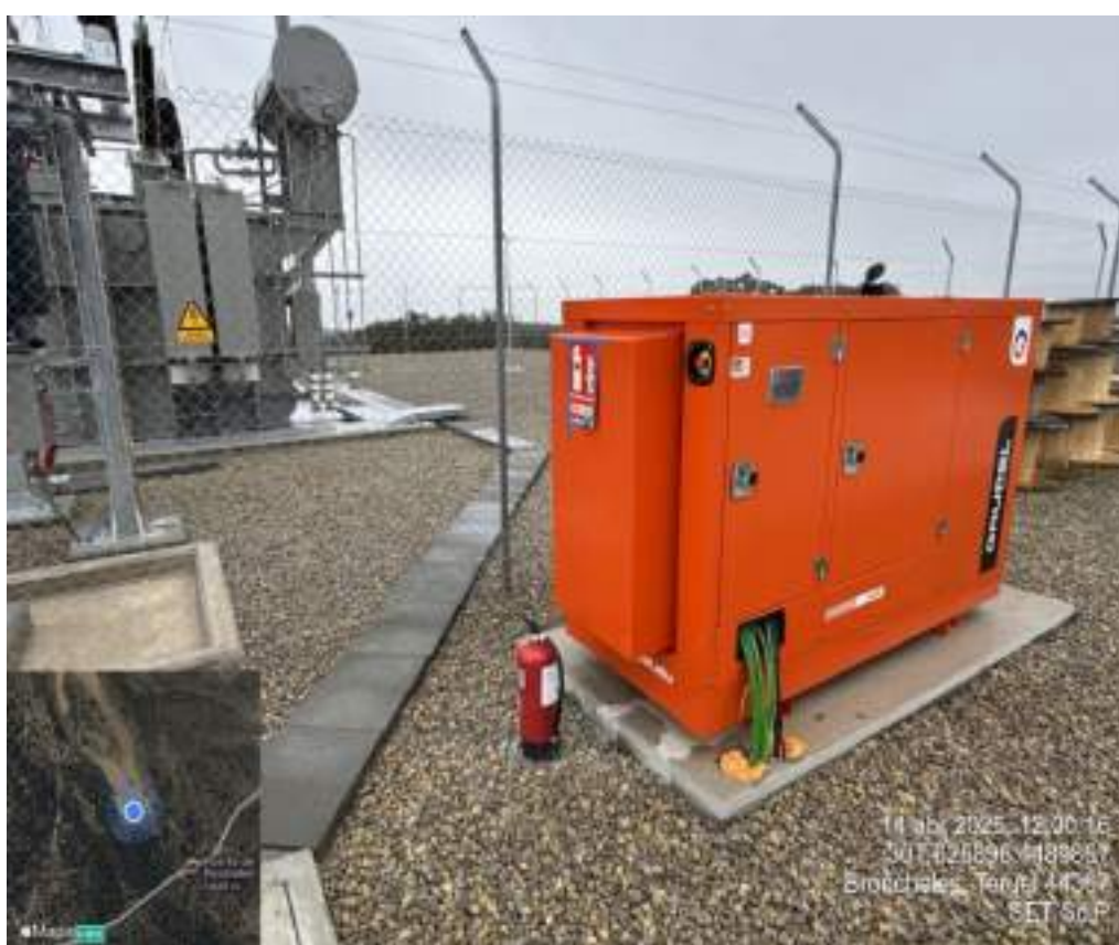
Fotografía 33. Extintor junto a grupo electrógeno
