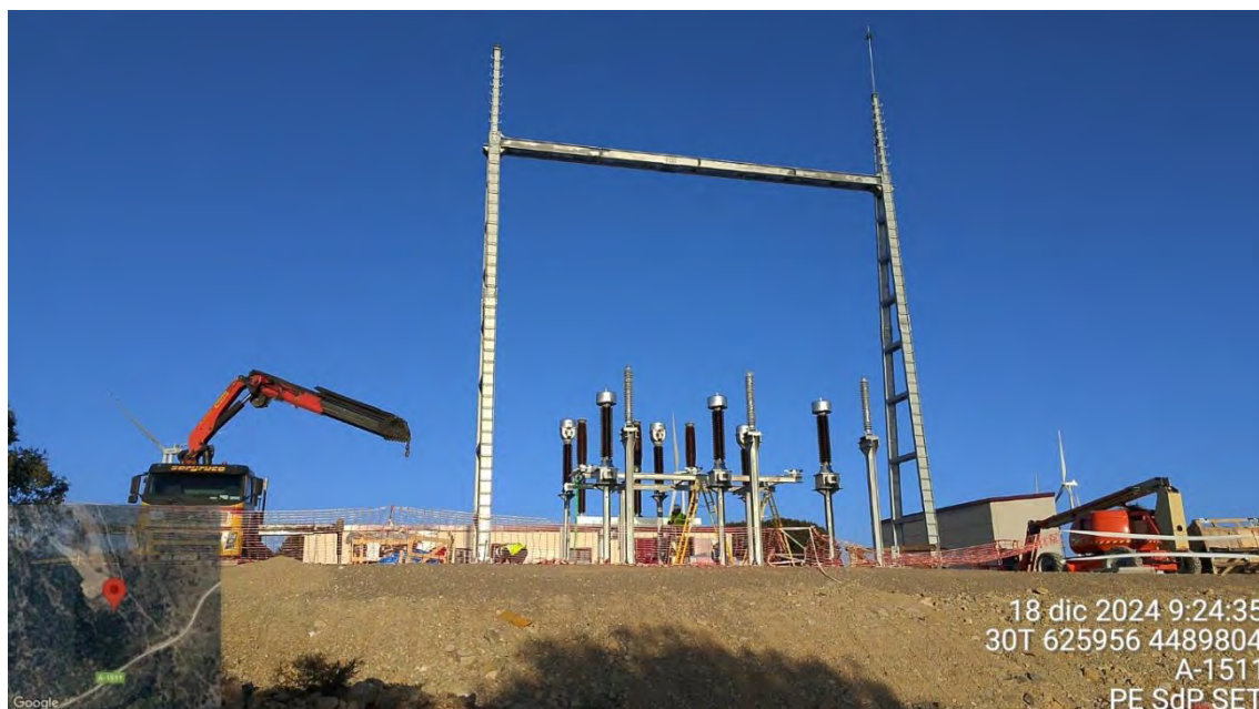
Fotografía 15. Vista de la SET desde el apoyo 1 de la LAAT
