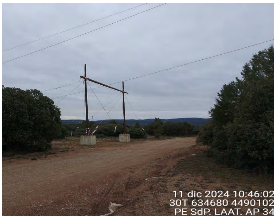
Fotografía 34. Estructura para evitar que el tendido caiga sobre el vial en caso de accidente
