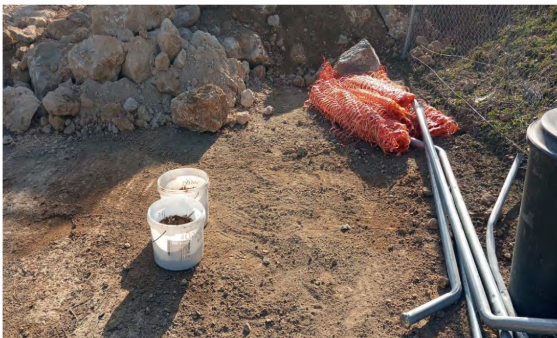
Fotografía 24. Recogida de la tierra contaminada del vertido del apoyo 55 de la LAAT (18/12/2024)
