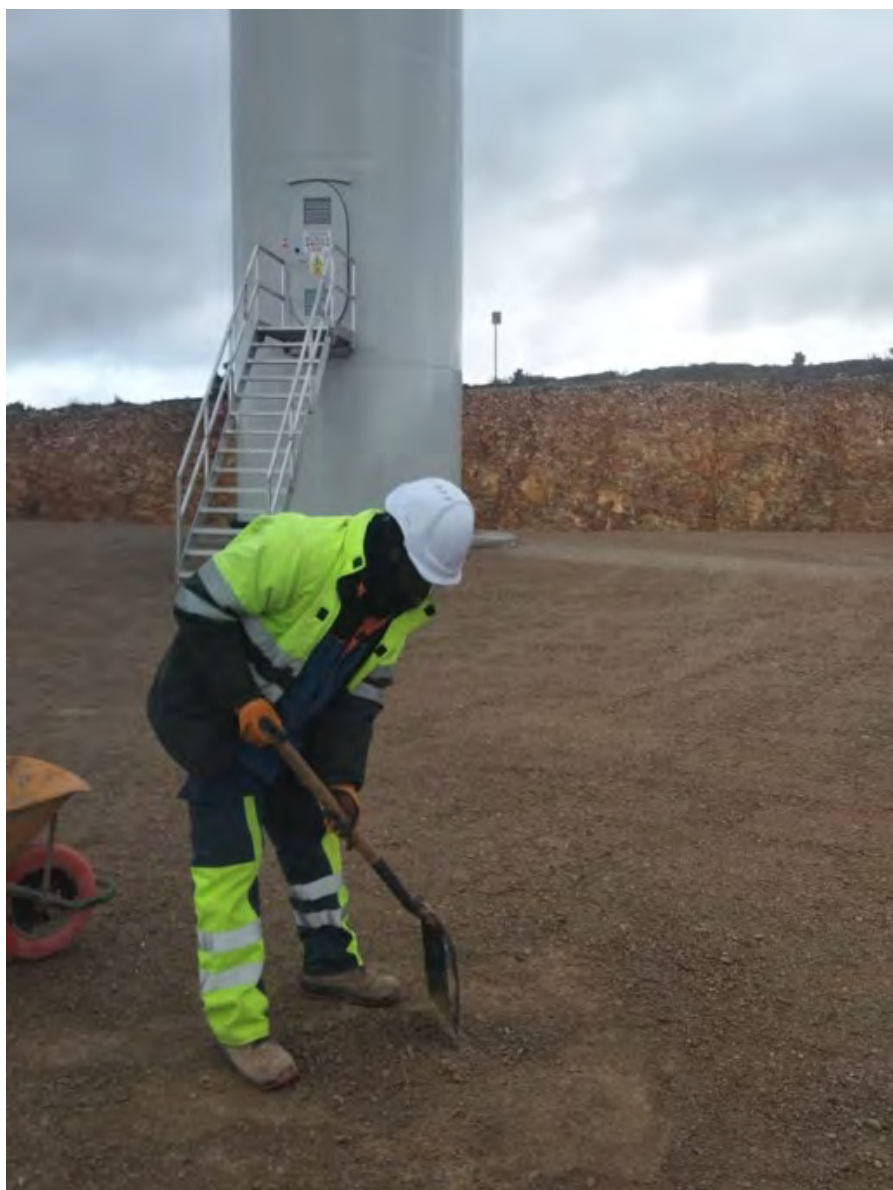
Fotografía 21. Limpieza del vertido y restitución del suelo junto al AE 1
