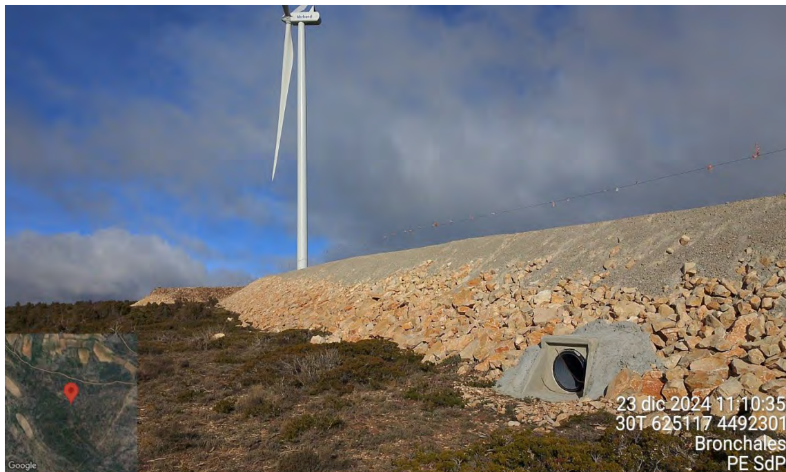
Fotografía 21. Red de drenaje de la rampa que da acceso al aerogenerador 1
