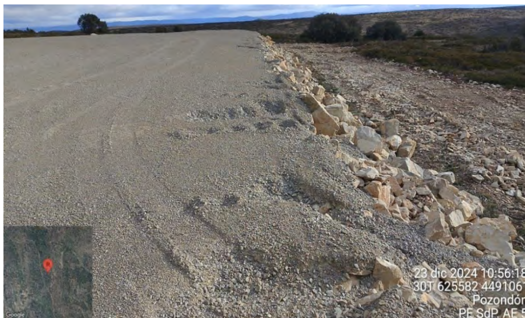
Fotografía 25. Efectos erosivos en la plataforma del AE 5
