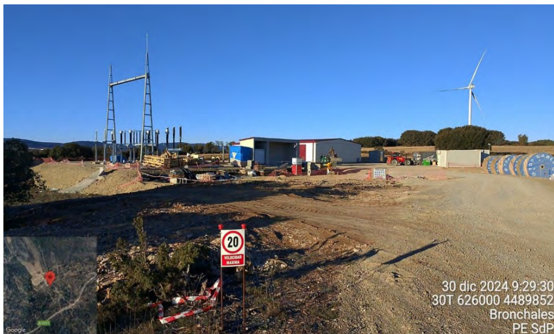
Fotografía 22. Vista general de la SET
