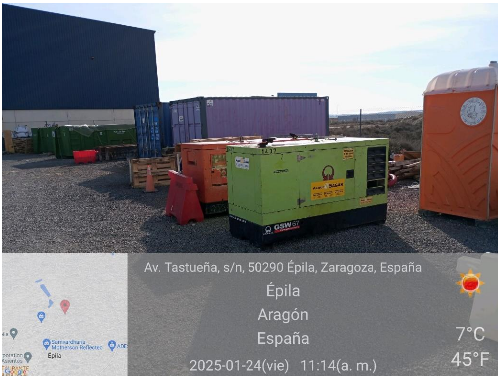
Ilustración 13. Generadores sin plástico aislante en el campsite.
