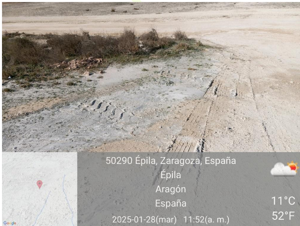
Ilustración 20. Vertido de hormigón mal corregido en la plataforma 06.
