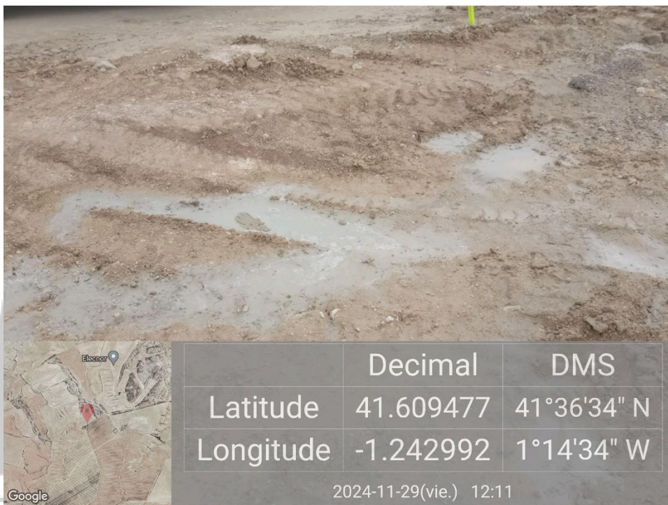
Ilustración 8. Limpieza de cuba de hormigón fuera de una zona aislada en el vial de acceso de la plataforma 05.
