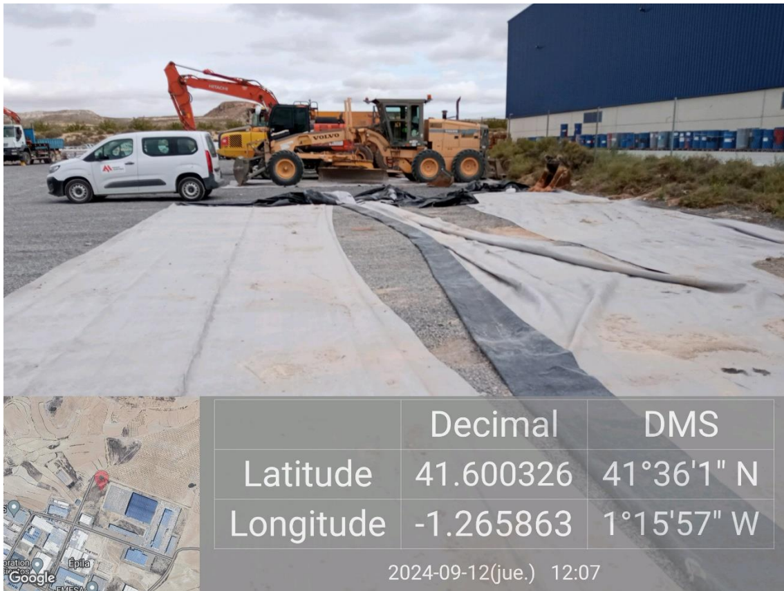
Ilustración 4. Plástico protector en aparcamiento de maquinaria mal colocado.
