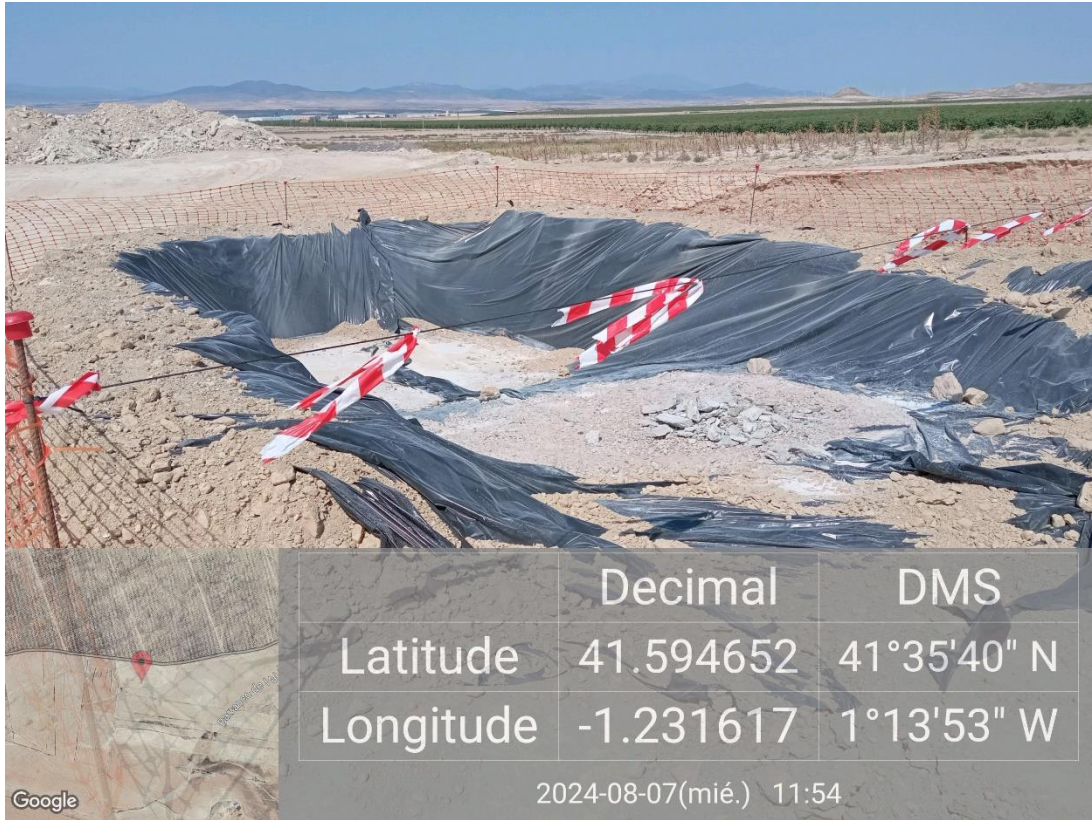
Ilustración 5. Balsa para la limpieza de cubas de hormigón de la plataforma 08 en buen estado de conservación.
