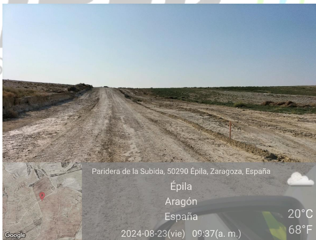
Ilustración 8. Ensanchamiento de vial sobrepasando el estaquillado
