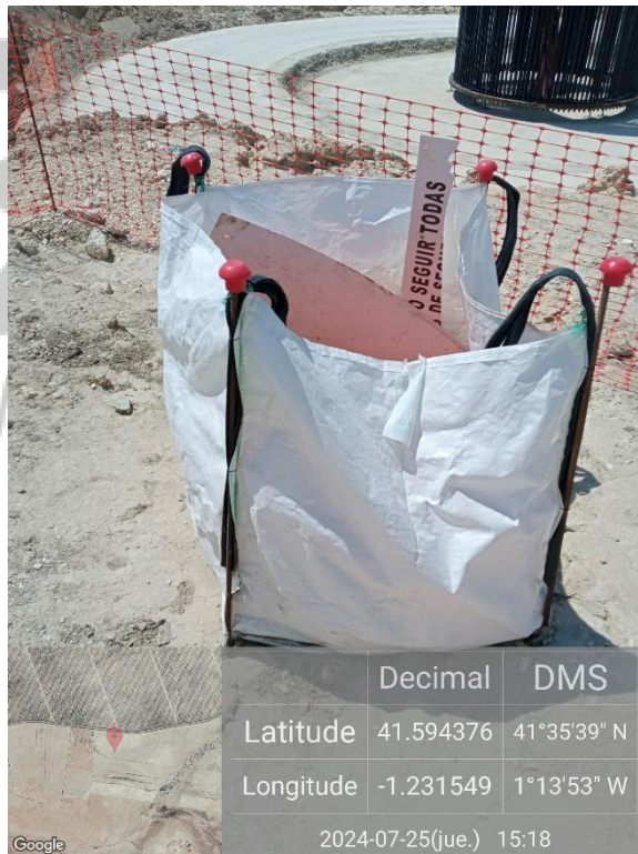
Ilustración 9. Basura de residuos no peligrosos en la plataforma del aerogenerador 08.
