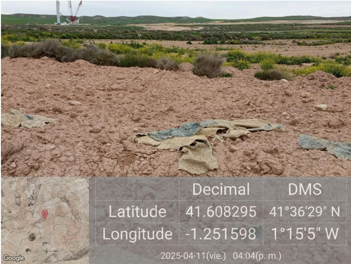
Ilustración 8. Residuo geotextil en el vial de acceso a la plataforma 03.
