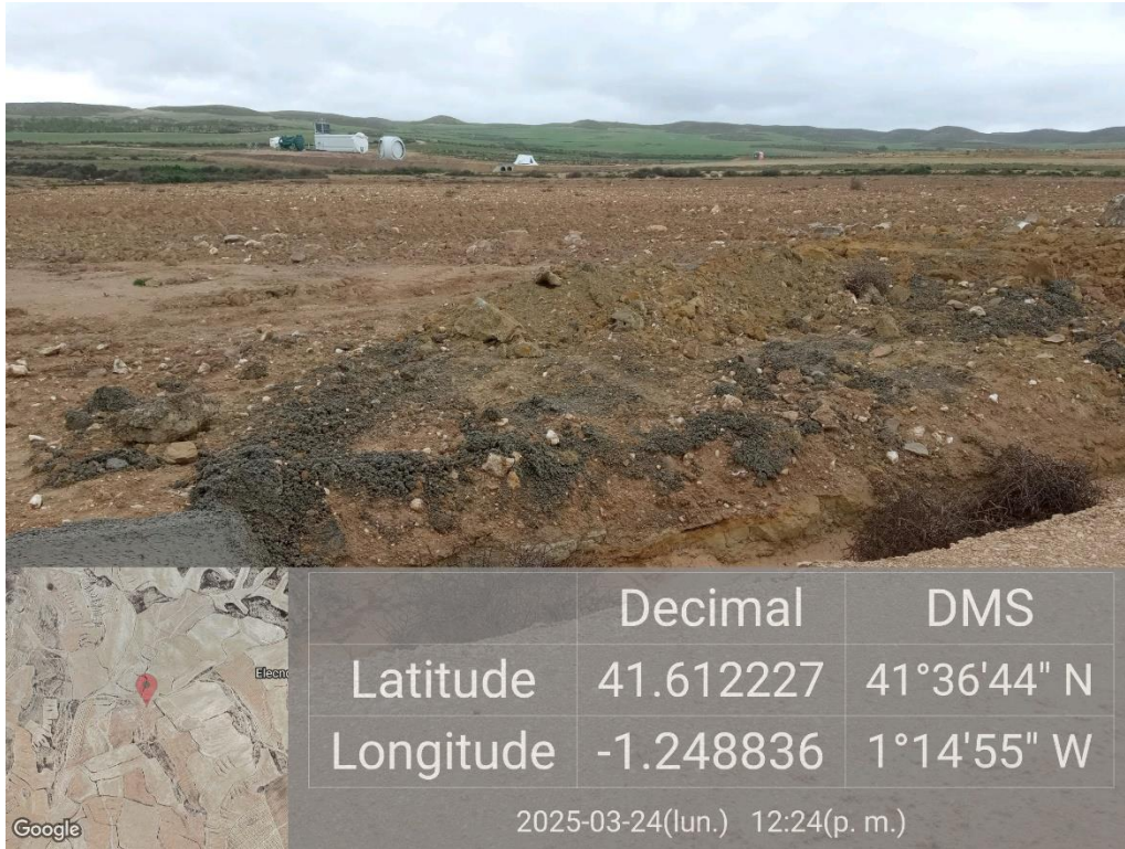
Ilustración 15. Residuos de hormigón junto al recorrido de las cunetas.
