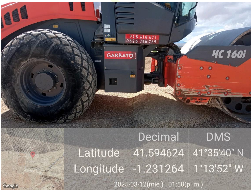
Ilustración 6. Máquina estacionada correctamente pero directamente sobre el suelo, sin lona que prevenga la infiltración de vertidos.
