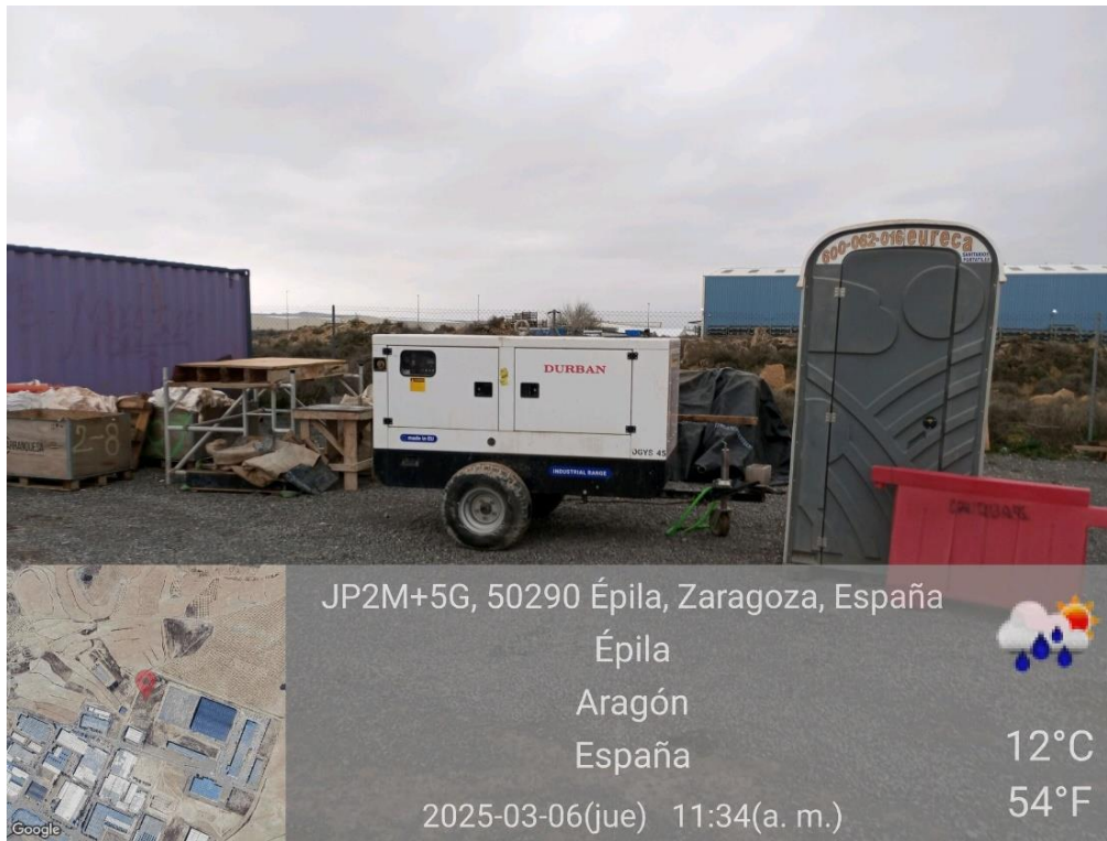
Ilustración 4. Generador ubicado en campsite apagado, pero sin lona
