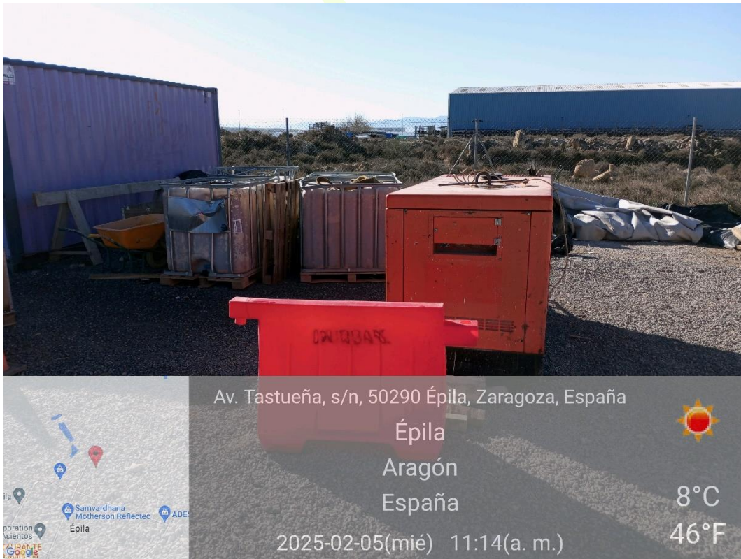
Ilustración 3. Generador del campsite sin material aislante antiderrame.
