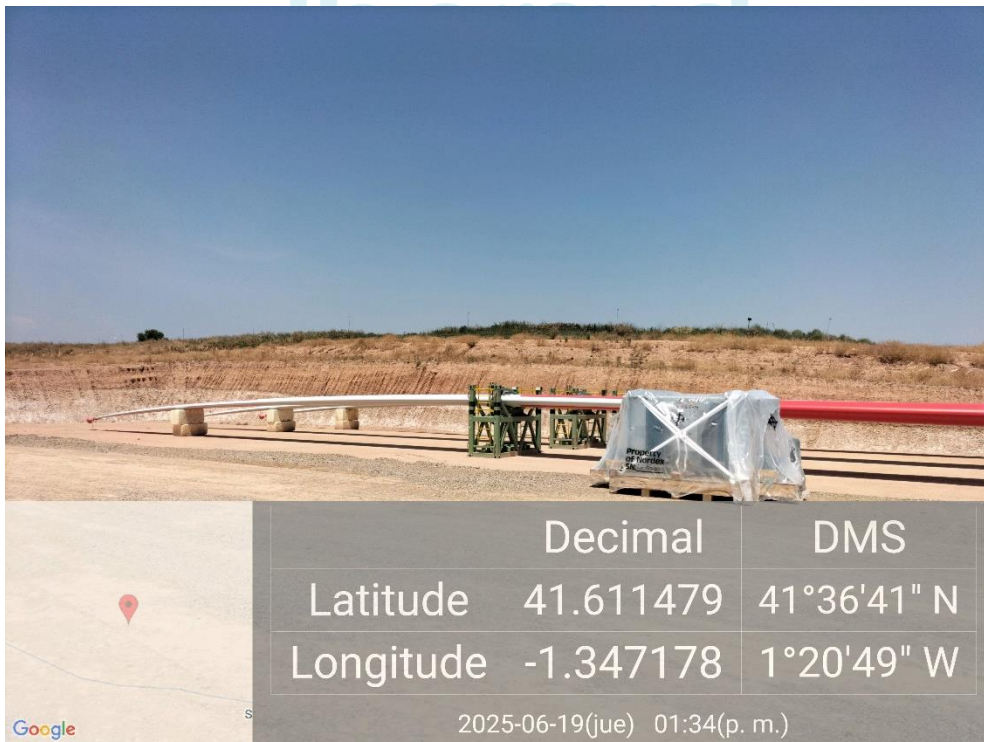
Ilustración 10. Acopio de palas sin afectar a la vegetación ni al drenaje natural.
