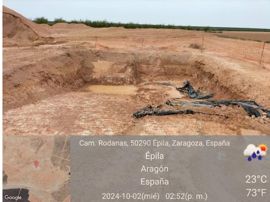
Ilustración 9. Balsa de la plataforma 05 en mal estado.
