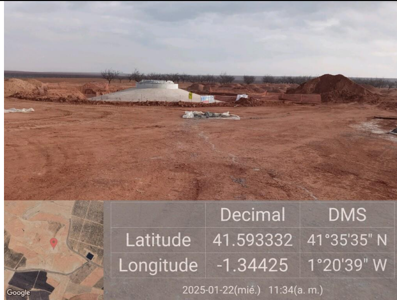
Ilustración 38. La situación en la plataforma 05 sigue estando igual sin corrección de los vertidos.
