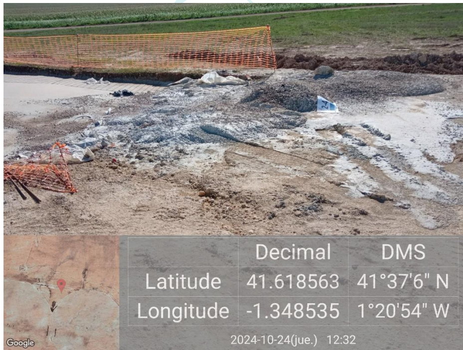
Ilustración 18. Restos de hormigón fuera de la balsa en la plataforma 04.
