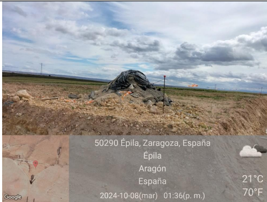
Ilustración 11. Acopio de resotos de balsa de hormigón por mucho tiempo en plataforma 04.
