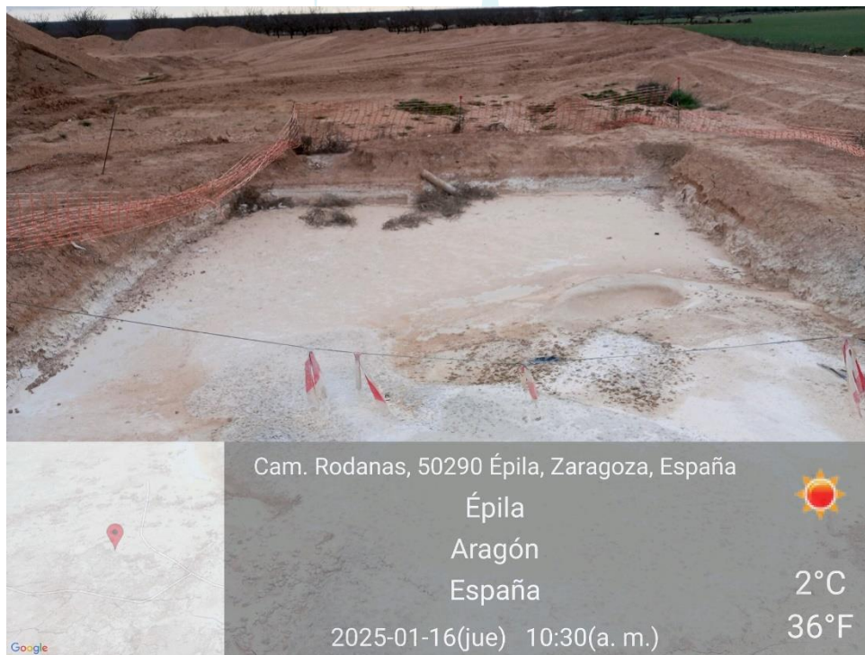
Ilustración 37. Balsa de hormigón sin plástico aislante.
