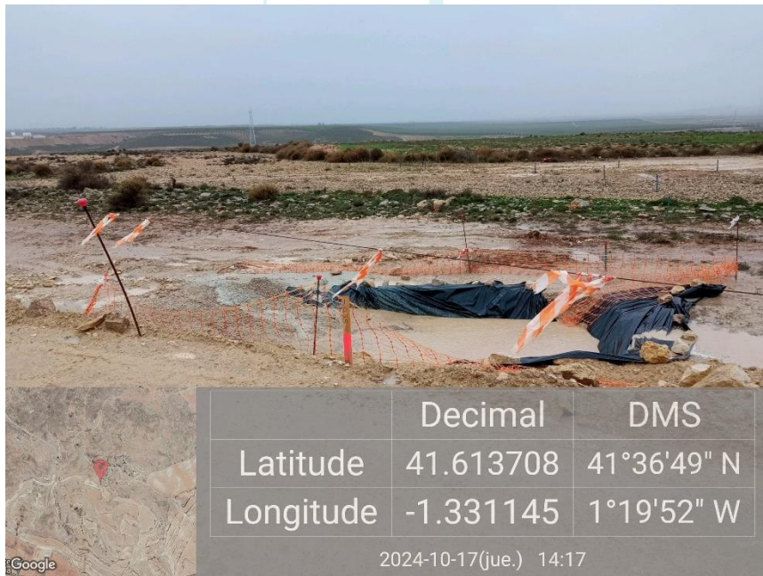
Ilustración 16. Restos de hormigón fuera de la balsa en la plataforma 04.
