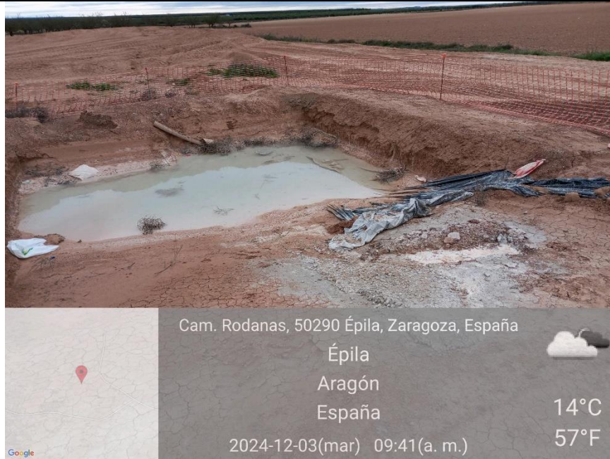
Ilustración 21. Balsa de hormigón sin material aislante y con hormigón fuera de la balsa en plataforma 05.
