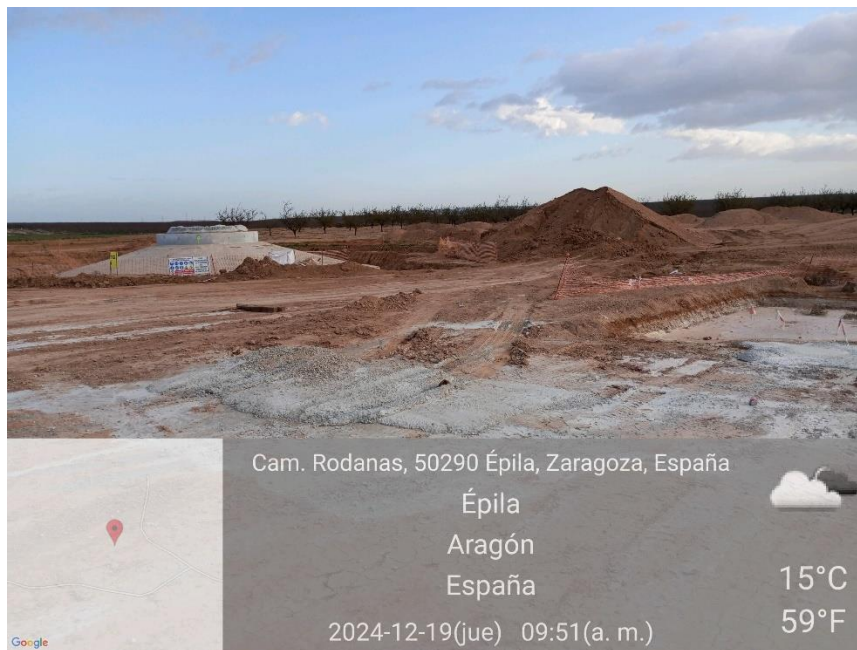
Ilustración 28. Limpiezas de hormigón fuera de la balsa.
