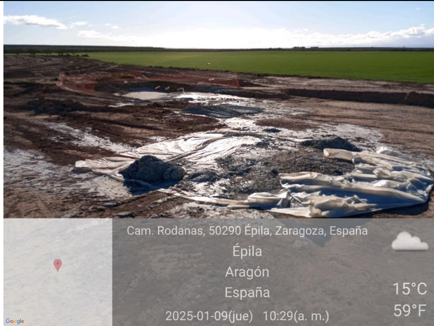
Ilustración 34. Limpiezas de hormigón fuera de la balsa.
