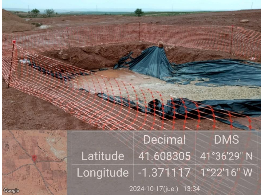
Ilustración 13. Balsa de hormigón en mal estado en plataforma 06.
