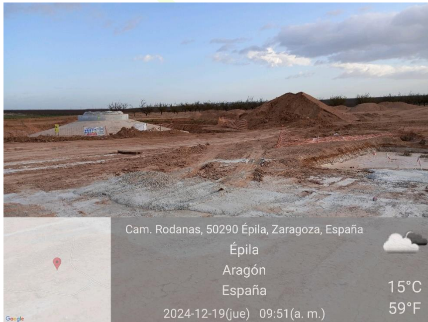
Ilustración 33. Limpiezas de hormigón fuera de la balsa.
