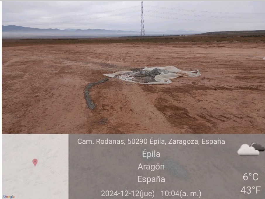
Ilustración 30. Limpiezas de hormigón fuera de la balsa.
