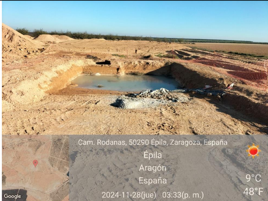
Ilustración 24. Balsa de hormigón sin material aislante y inundado en plataforma 05.
