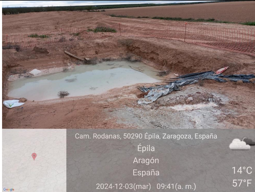
Ilustración 26. Balsa de hormigón sin material aislante y con hormigón fuera de la balsa en plataforma 05.
