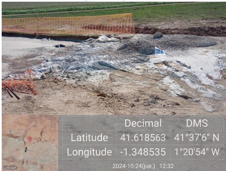
Ilustración 23. Restos de hormigón fuera de la balsa en la plataforma 04.
