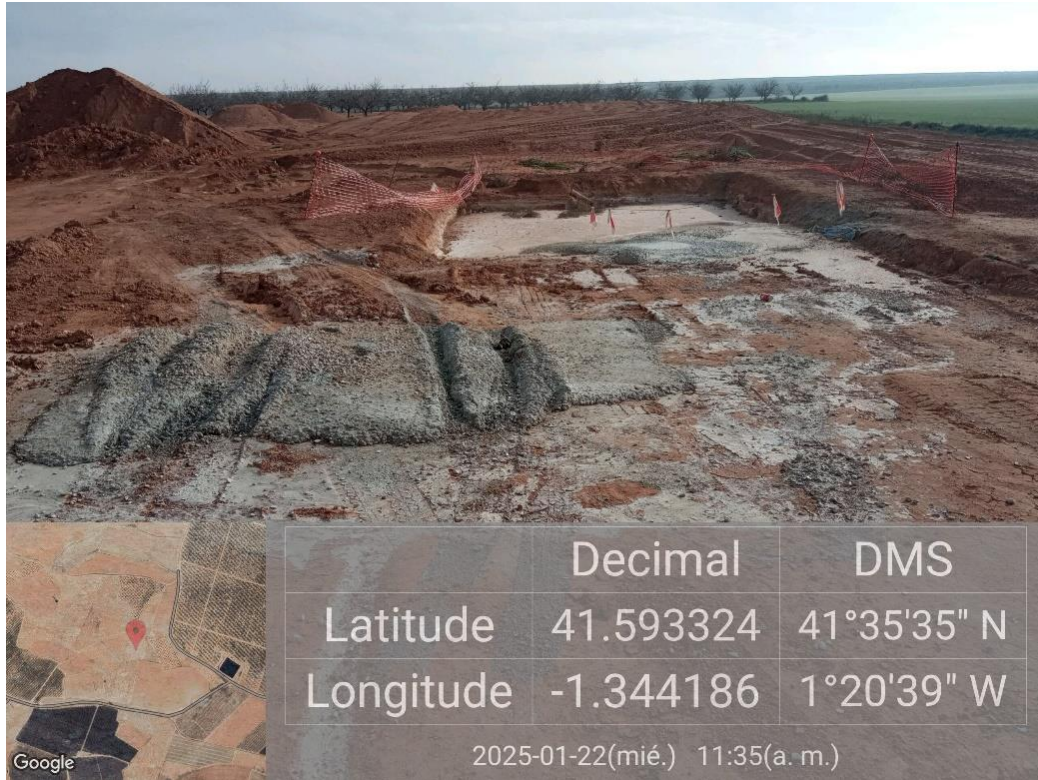
Ilustración 43. Plataforma 05 sin corrección de los vertidos de hormigón.
