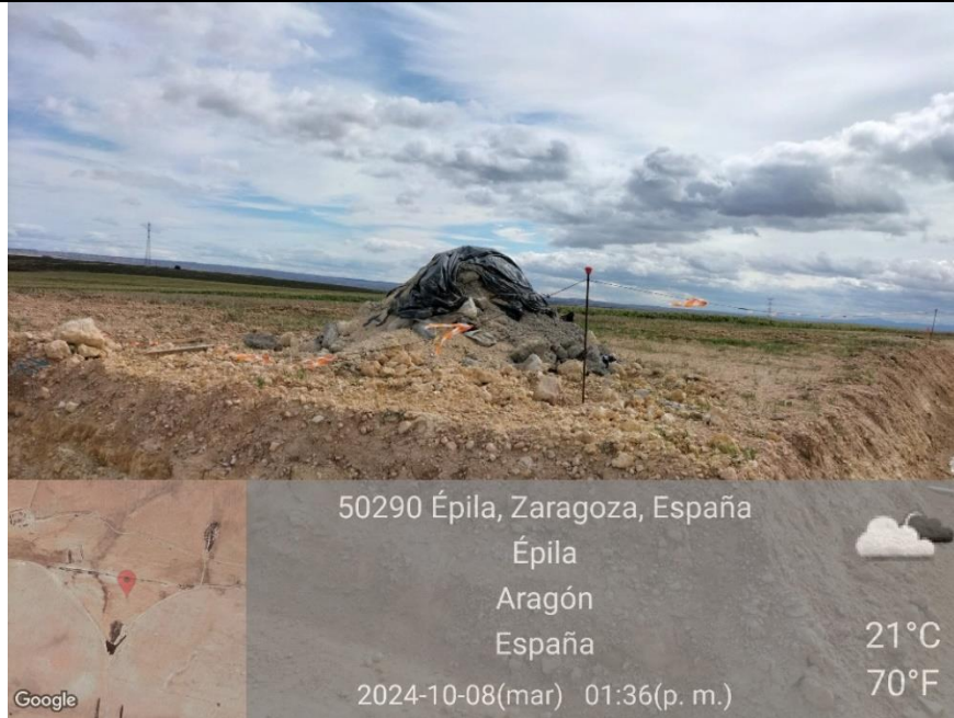
Ilustración 16. Acopio de resotos de balsa de hormigón por mucho tiempo en plataforma 04.
