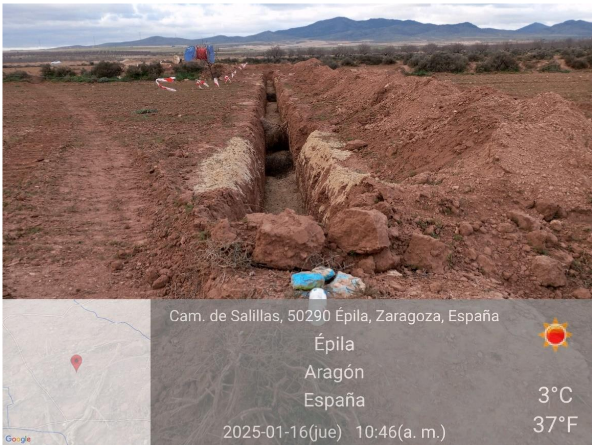
Ilustración 7. Aerosol tirado en la plataforma 02.
