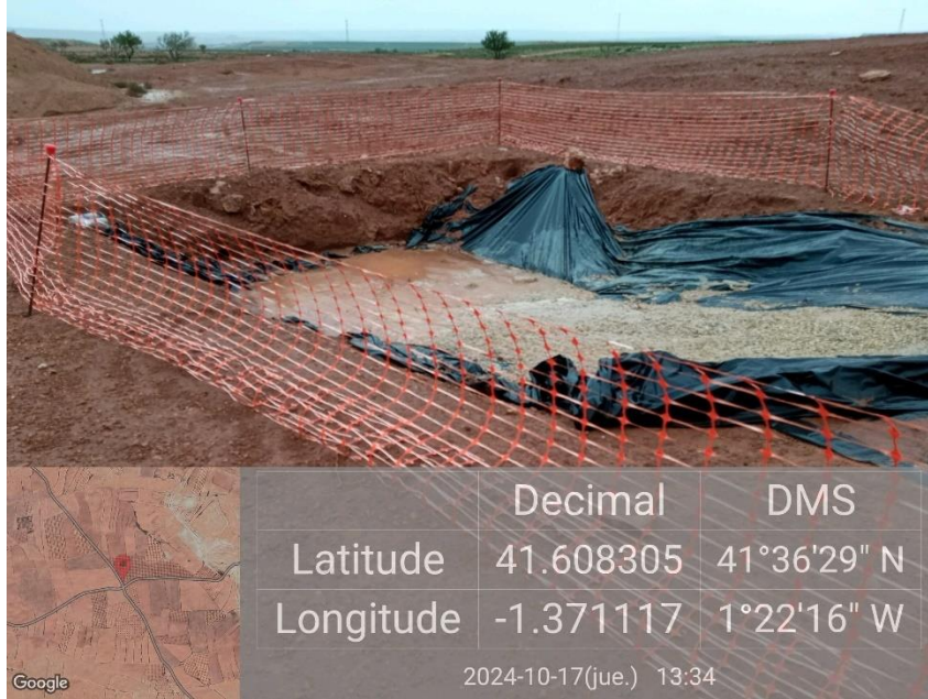
Ilustración 18. Balsa de hormigón en mal estado en plataforma 06.
