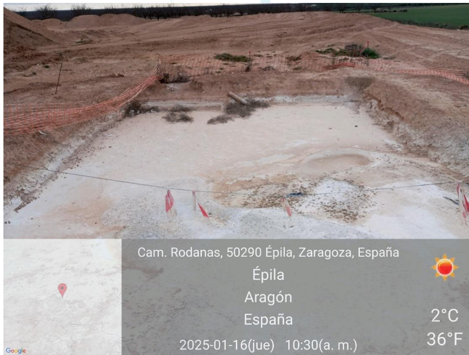
Ilustración 42. Balsa de hormigón sin plástico aislante.
