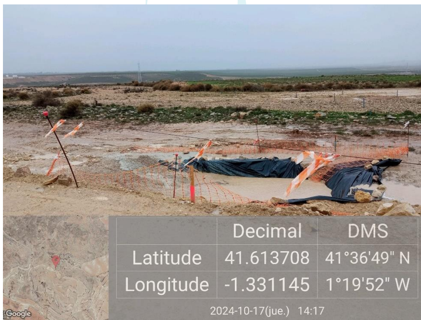
Ilustración 21. Restos de hormigón fuera de la balsa en la plataforma 04.
