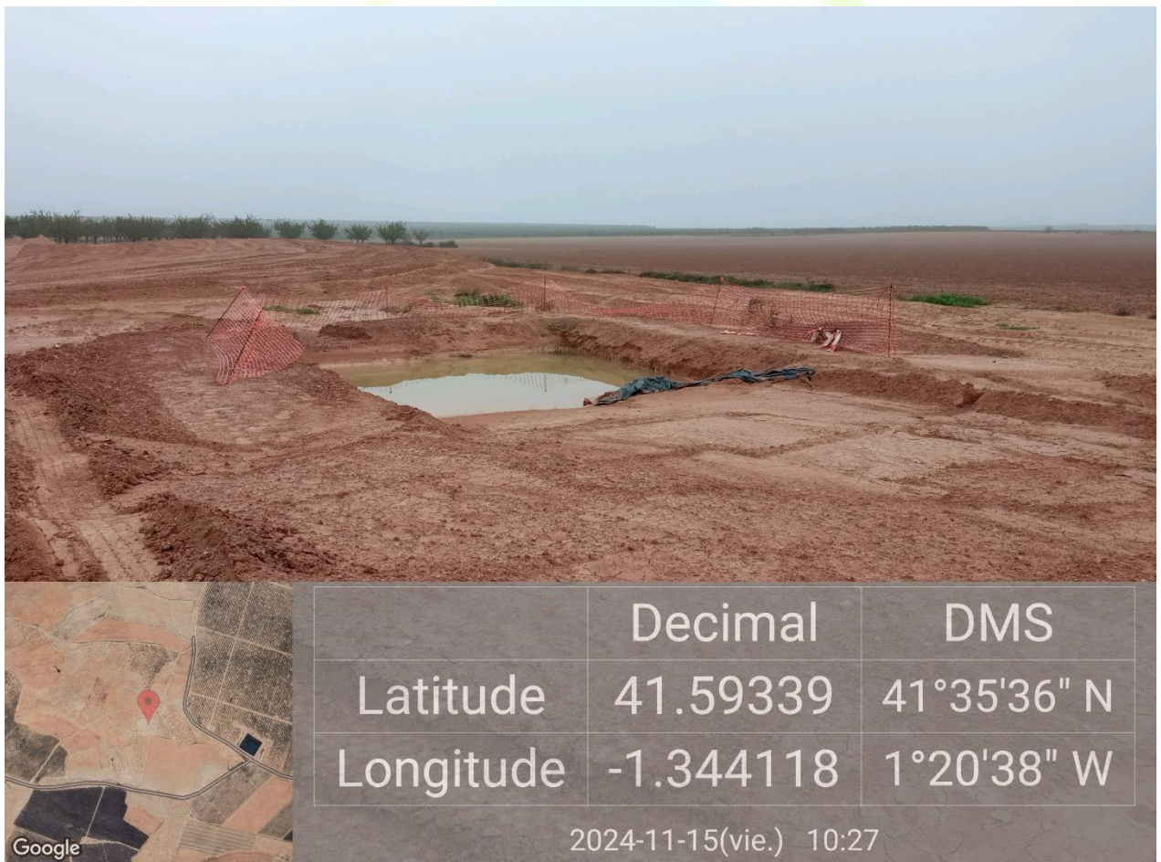
Ilustración 6. Balsa de hormigón de la plataforma 05 sin plástico aislante.
