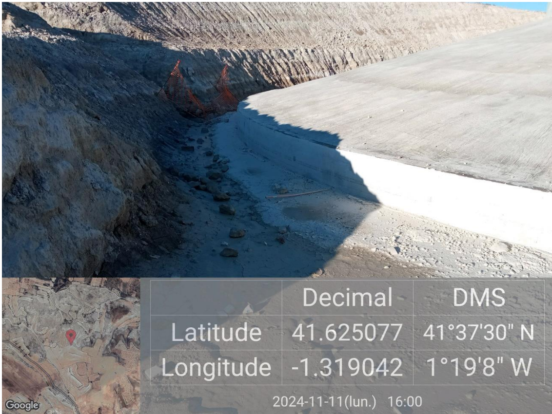
Ilustración 4. Residuos en la zanja de la plataforma 08
