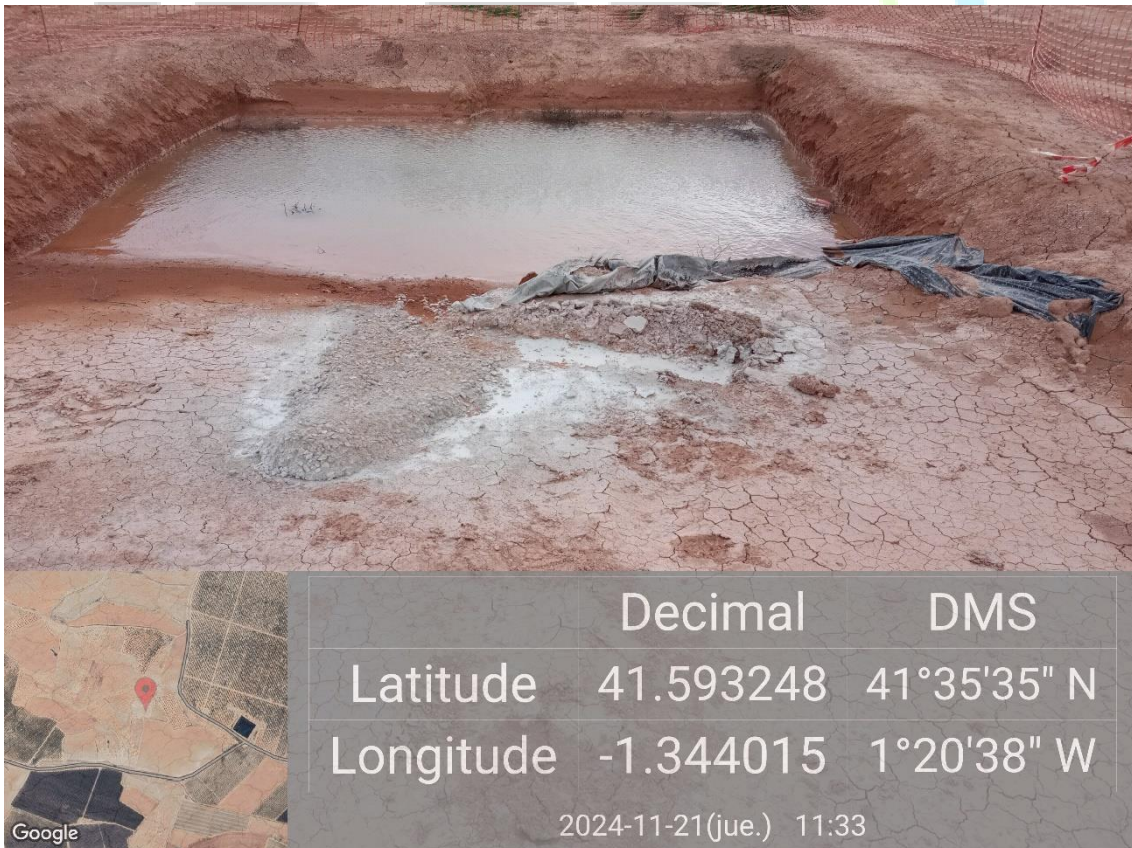
Ilustración 8. Balsa de hormigón de la plataforma 05 con el plástico desprendido y habiéndose realizado una limpieza de cuba de hormigón sin uso del aislante.
