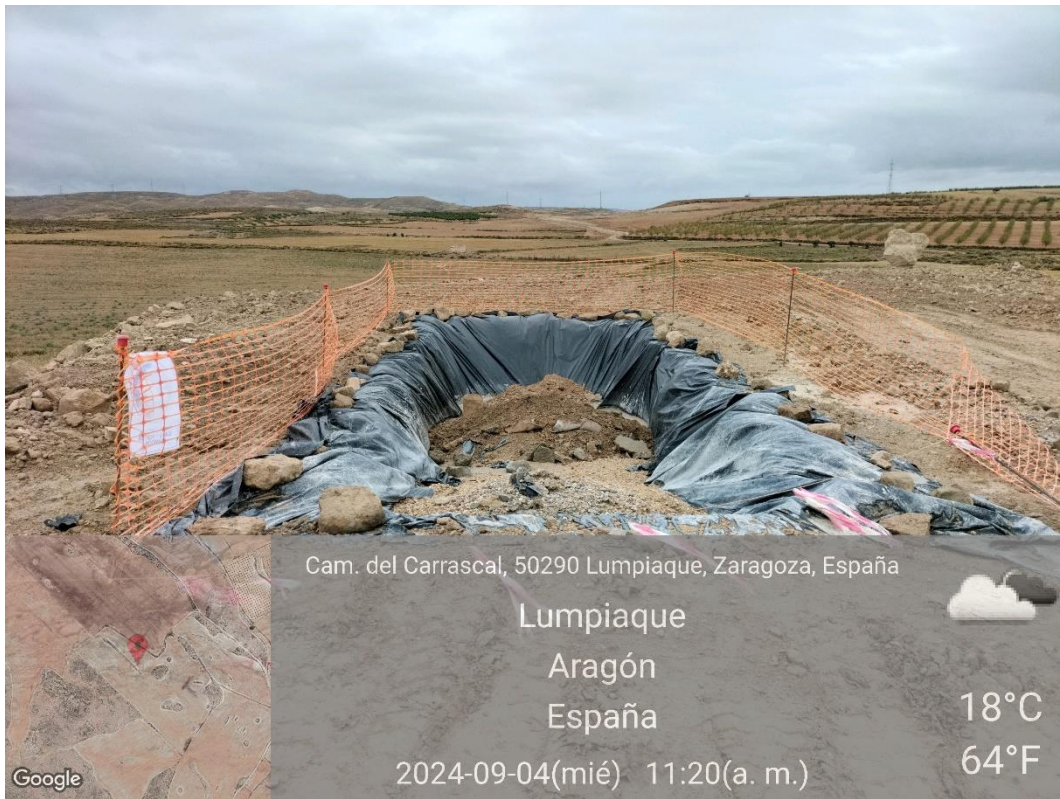
Ilustración 2. Balsa para la limpieza de hormigón en buen estado de la plataforma 07.
