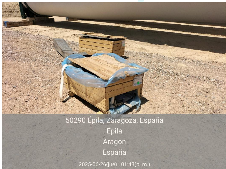
Ilustración 4. Cajas se usan de contenedor provisional para evitar la dispersión de residuos.
