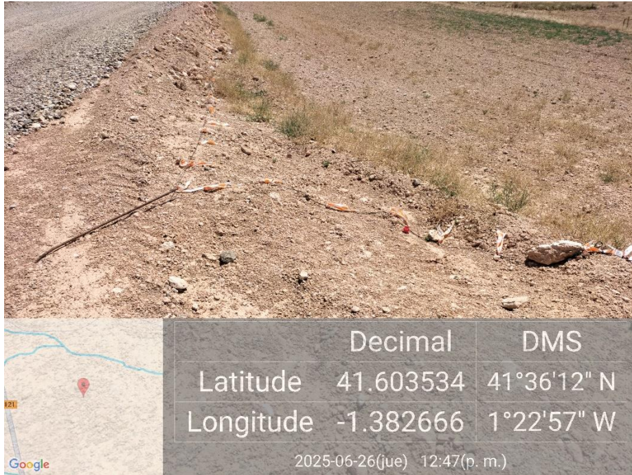
Ilustración 11. Balizado caído en plataforma 03.
