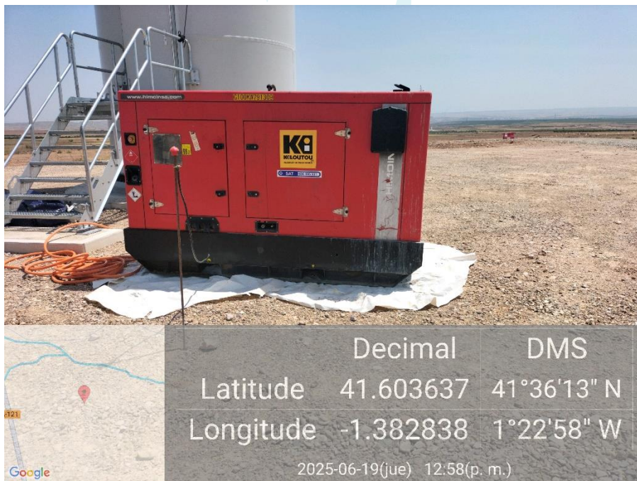
Ilustración 8. Generador sobre lona para prevenir vertidos directos al suelo.
