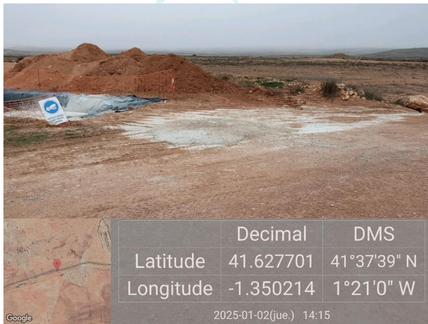
Ilustración 40. Balsa de hormigón llena resultando en un vertido de hormigón en la plataforma 08.
