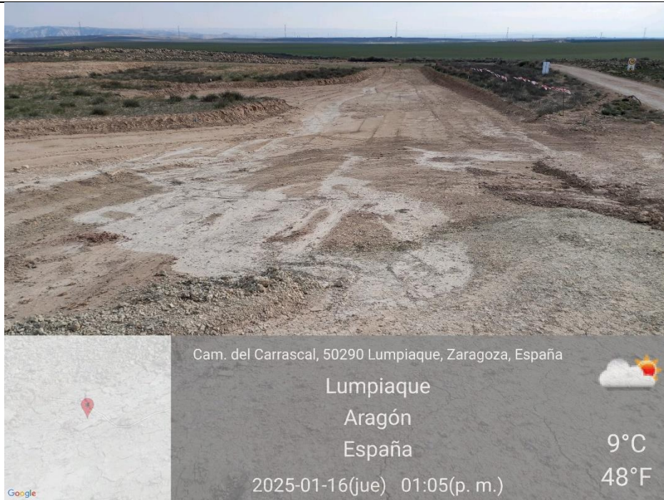
Ilustración 47. Corrección del vertido mal hecho en la plataforma 06.
