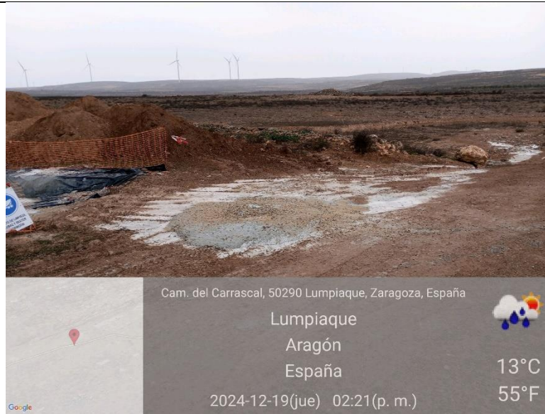
Ilustración 37. Limpieza de hormigón fuera de la balsa causando vertido de hormigón.
