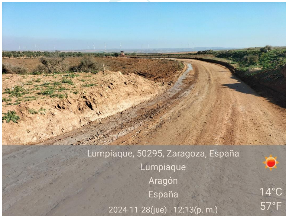
Ilustración 32. Extensión del vertido en la plataforma 01.
