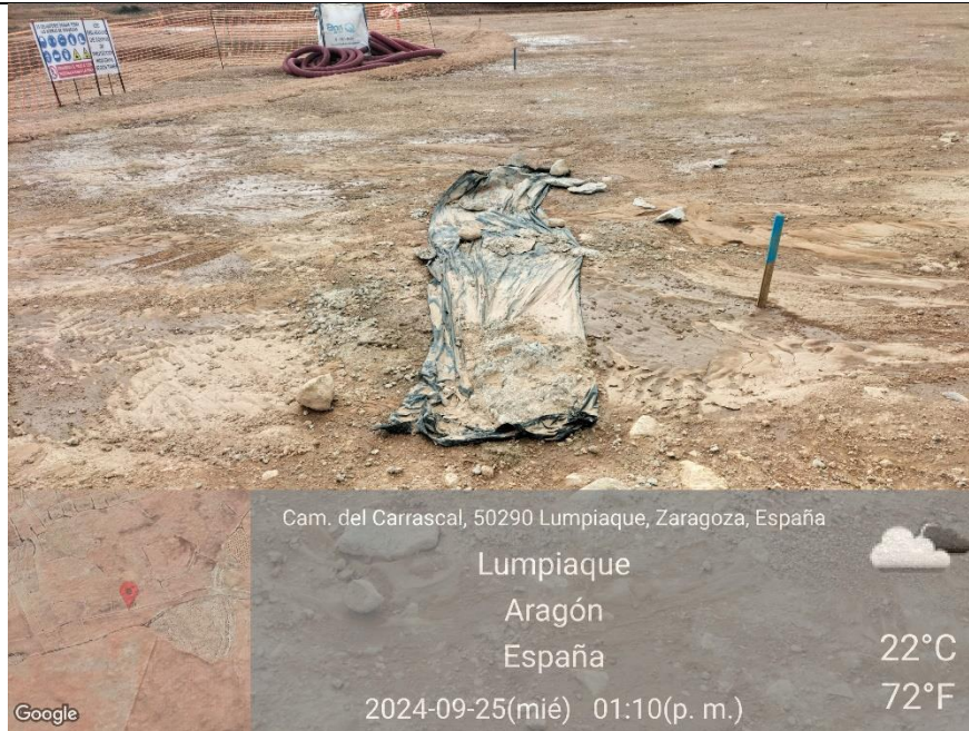
Ilustración 13. Limpieza de hormigón fuera de plástico protector en plataforma 08 de la visita anterior sin recoger.
