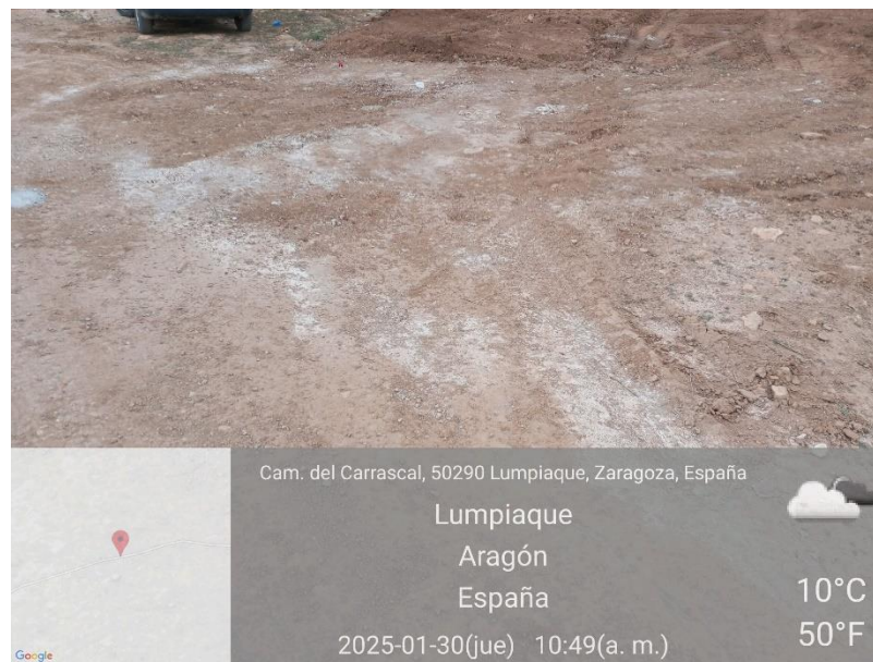
Ilustración 52. Corrección de vertidos de hormigón en la plataforma 08.
