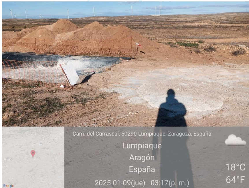
Ilustración 42. Vertido y balsa de hormigón sin corrección en la plataforma 08.
