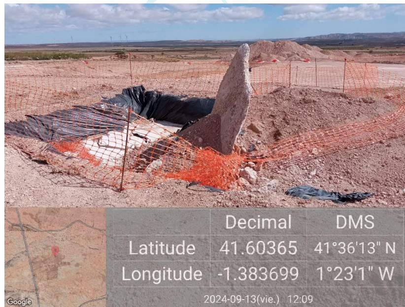
Ilustración 8. Balsa de plataforma 03 en mal estado.
