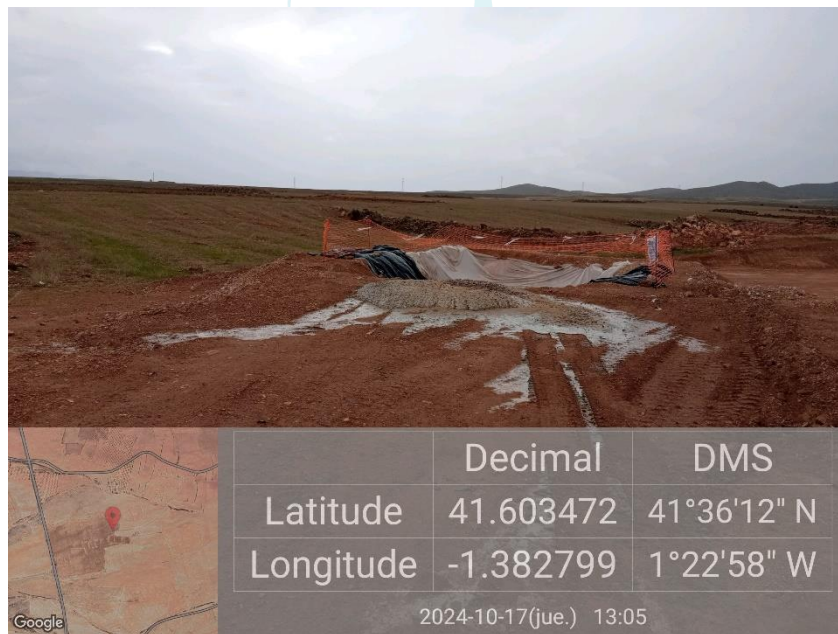
Ilustración 16. Continúa sin gestionar los restos de la limpieza de cuba hecha fuera de la balsa de la plataforma 03 realizada en las visitas anteriores.
