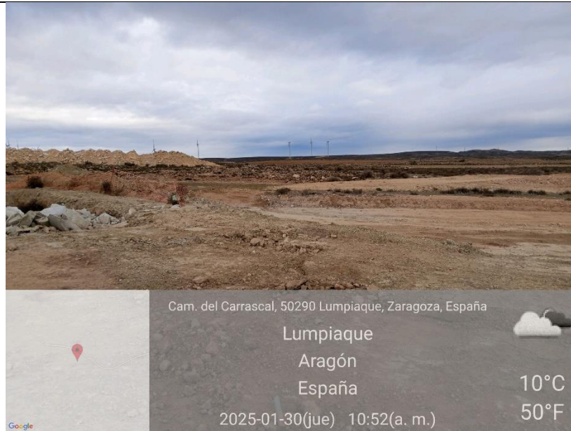
Ilustración 51. Corrección de la balsa de hormigón en la plataforma 06.
