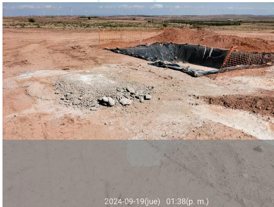
Ilustración 10. Limpieza de cuba de hormigón realizada fuera de la balsa de la plataforma 01.
