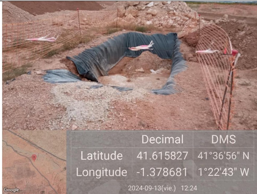
Ilustración 9. Balsa de la plataforma 05 sin ser corregida
