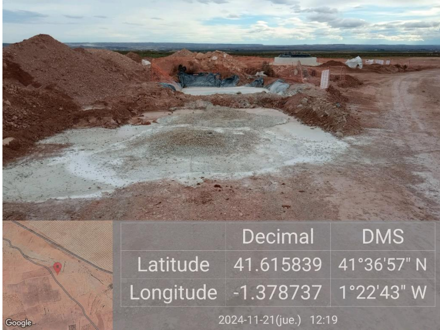
Ilustración 27. Nuevamente limpieza de hormigón hecha fuera de la balsa de la plataforma 05 y anterior sin corregir.
