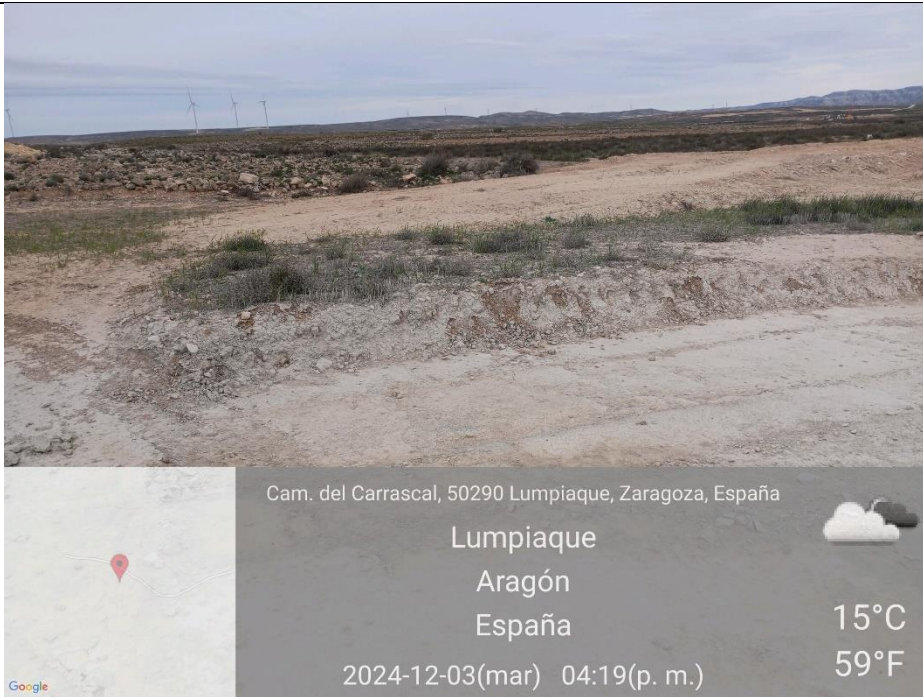
Ilustración 33. Vertido de hormigón fuera de la balsa.
