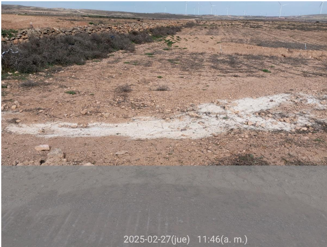
Ilustración 56. Vertido de hormigón no corregido.
