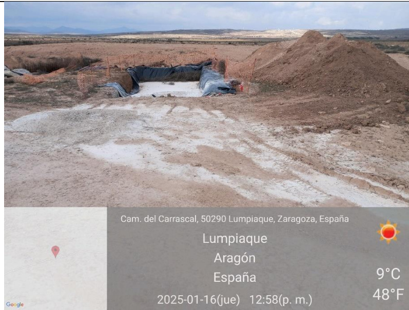
Ilustración 45. Vertido de hormigón sin corrección en la plataforma 08.
