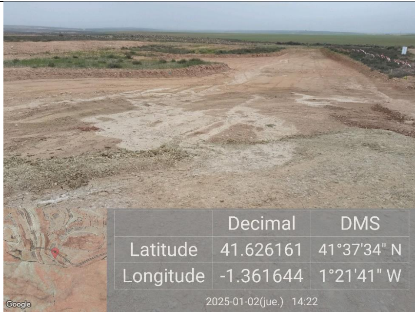
Ilustración 41. Corrección del vertido de hormigón mal hecho en la plataforma 06.
