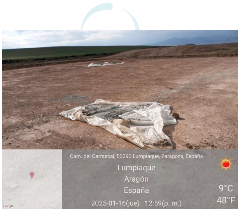
Ilustración 46. Limpiezas de hormigón fuera de la balsa.
