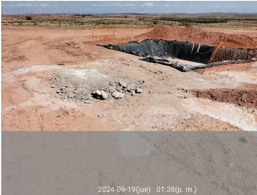
Ilustración 20. Limpieza de cuba de hormigón realizada fuera de la balsa de la plataforma 01.
