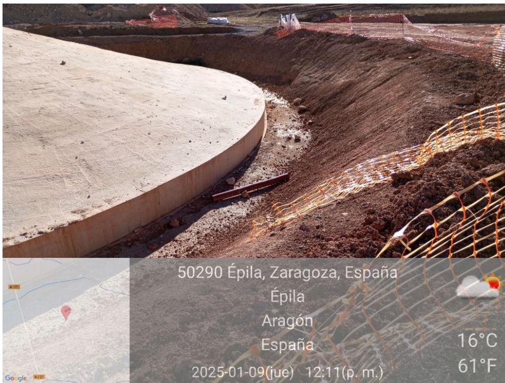
Ilustración 7. Residuos dispersos en una zanja.
