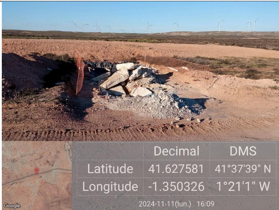
Ilustración 33. Continúa limpieza fuera de balsa sin corregir en la plataforma 08.
