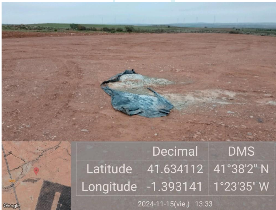
Ilustración 36. Continúa limpieza fuera de plástico aislante sin corregir en la plataforma 01.
