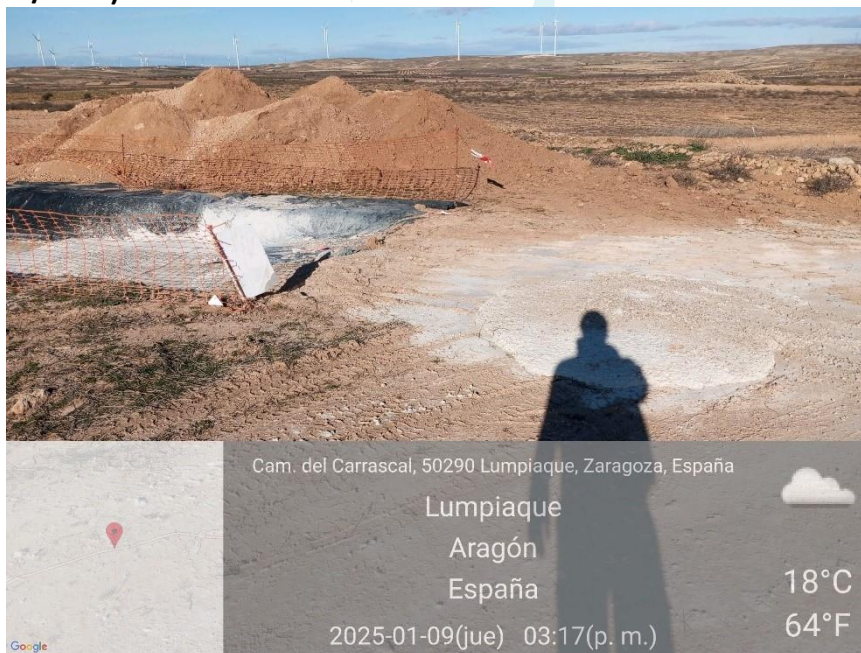
Ilustración 52. Vertido y balsa de hormigón sin corrección en la plataforma 08.
