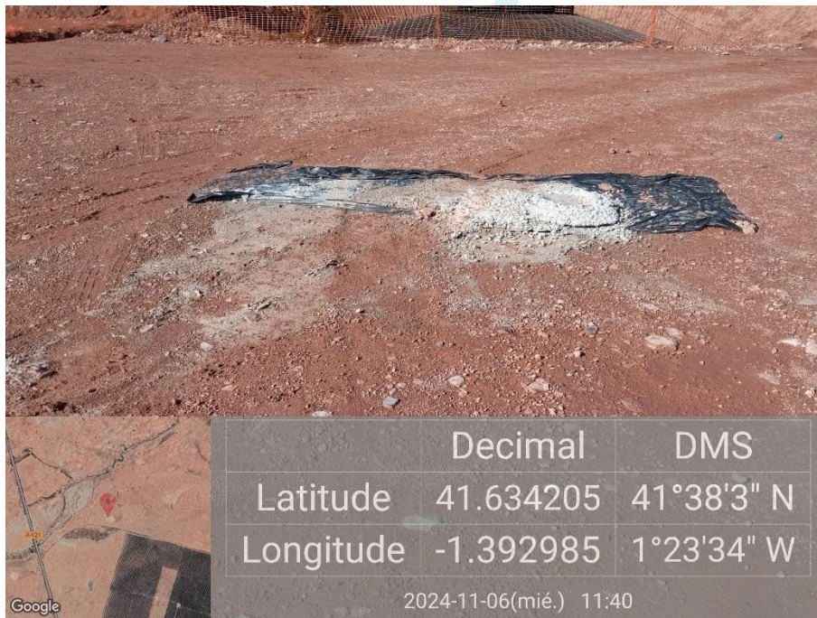
Ilustración 32. Continúa limpieza fuera de plástico aislante sin corregir en la plataforma 01.
