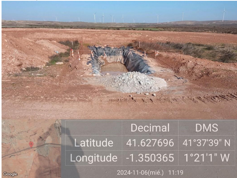
Ilustración 31. Continúa limpieza fuera de balsa sin corregir en la plataforma 08.
