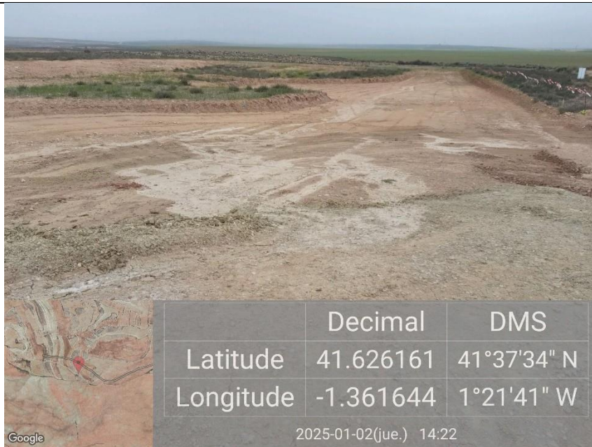
Ilustración 51. Corrección del vertido de hormigón mal hecho en la plataforma 06.
