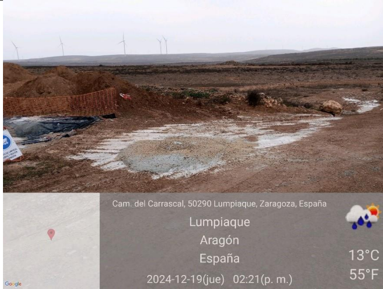
Ilustración 47. Limpieza de hormigón fuera de la balsa causando vertido de hormigón.
