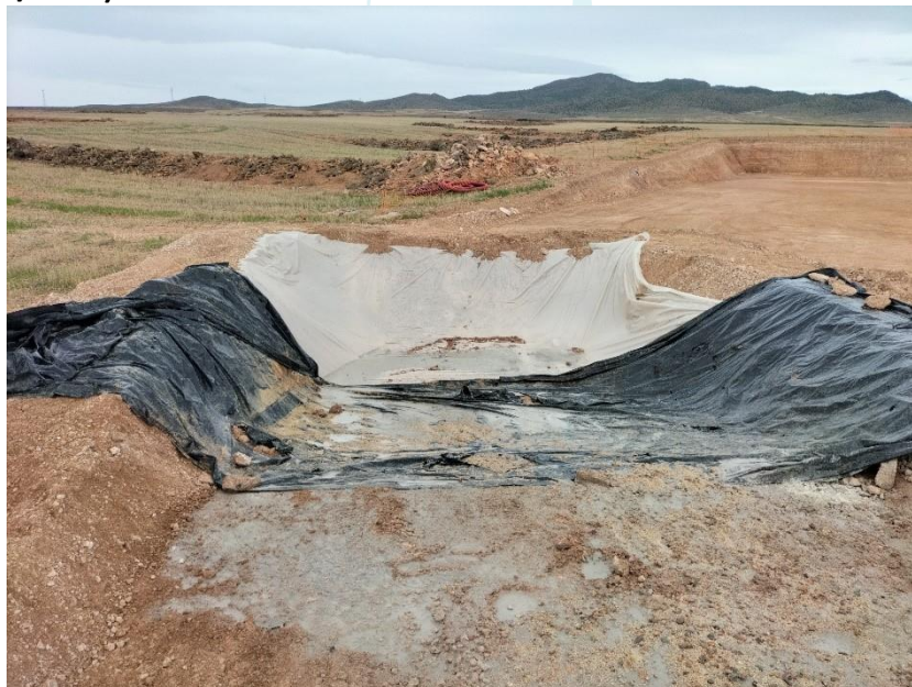
Ilustración 24. Limpieza de cuba de hormigón hecha fuera de la zona aislada de la balsa de la plataforma 03.
