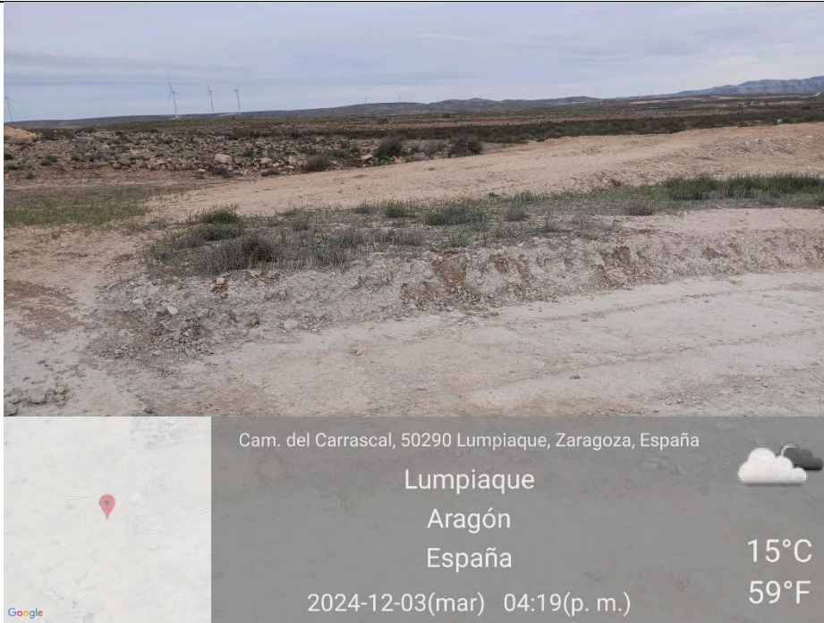
Ilustración 43. Vertido de hormigón fuera de la balsa.
