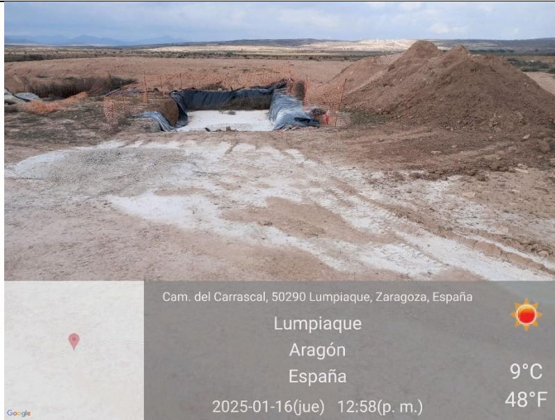
Ilustración 55. Vertido de hormigón sin corrección en la plataforma 08.
