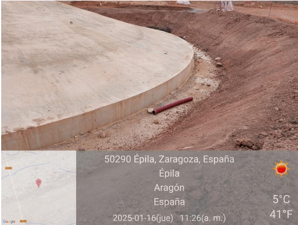
Ilustración 59. Zanja con residuos.
