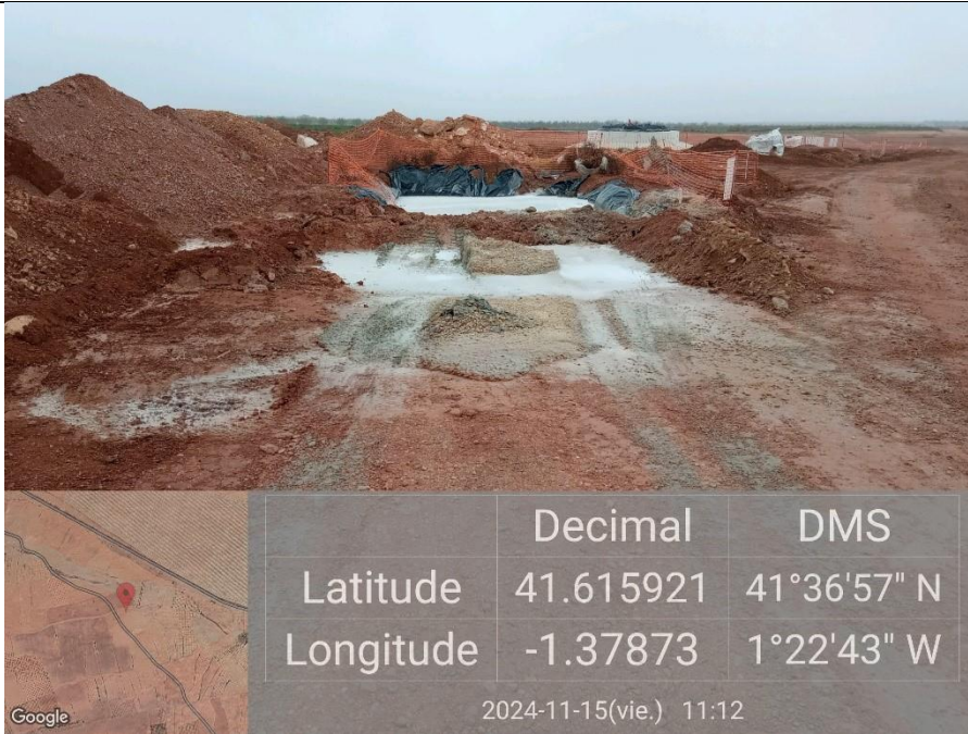
Ilustración 35. Limpieza de hormigón realizada totalmente fuera de la balsa de la plataforma 05.
