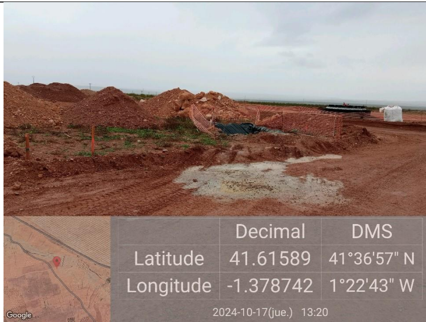
Ilustración 27. Vertido de agua de limpieza de cubas fuera de la balsa de la plataforma 05.
