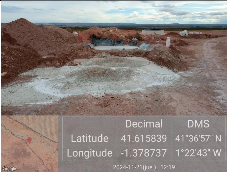
Ilustración 37. Nuevamente limpieza de hormigón hecha fuera de la balsa de la plataforma 05 y anterior sin corregir.
