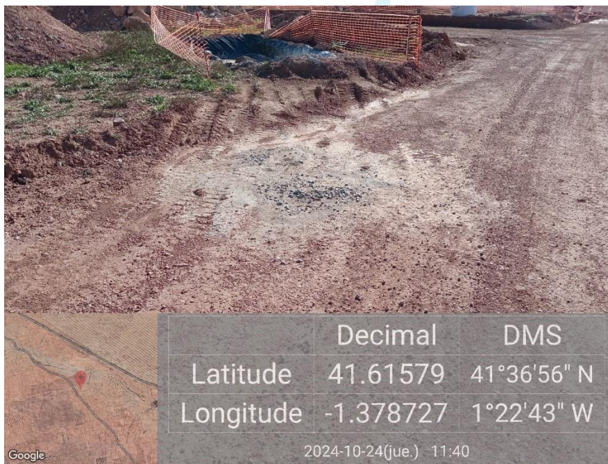
Ilustración 28. Limpieza de hormigón hecha fuera de la balsa en la plataforma 05 todavía sin corregir.
