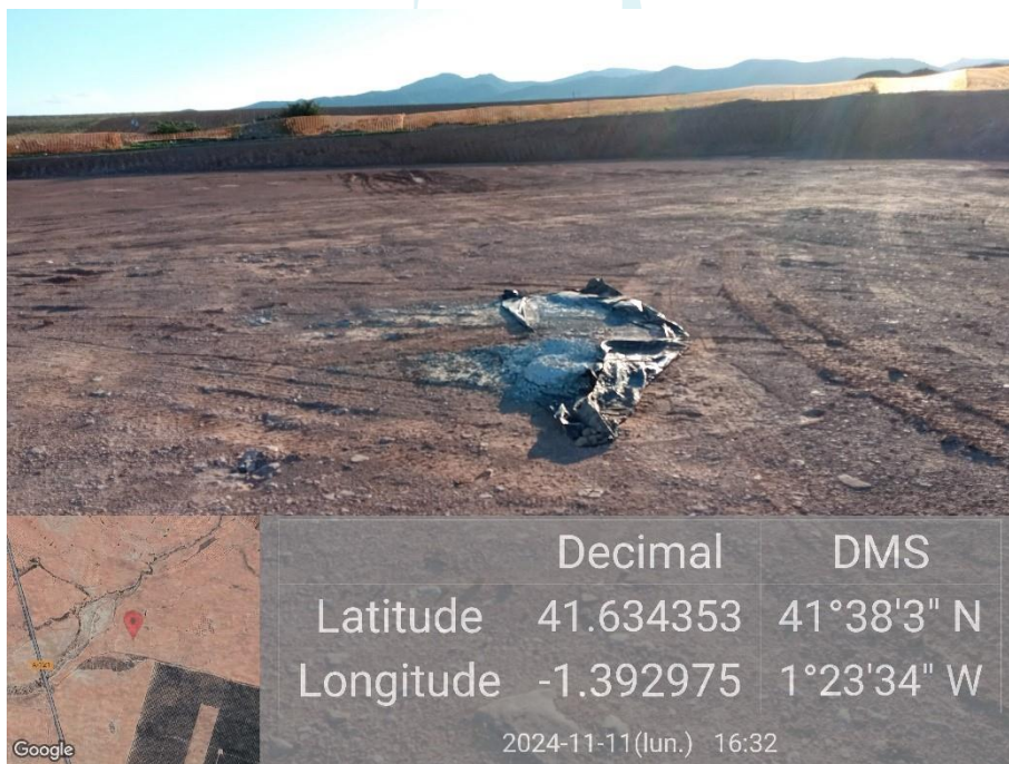
Ilustración 34. Continúa limpieza fuera de plástico aislante sin corregir en la plataforma 01.
