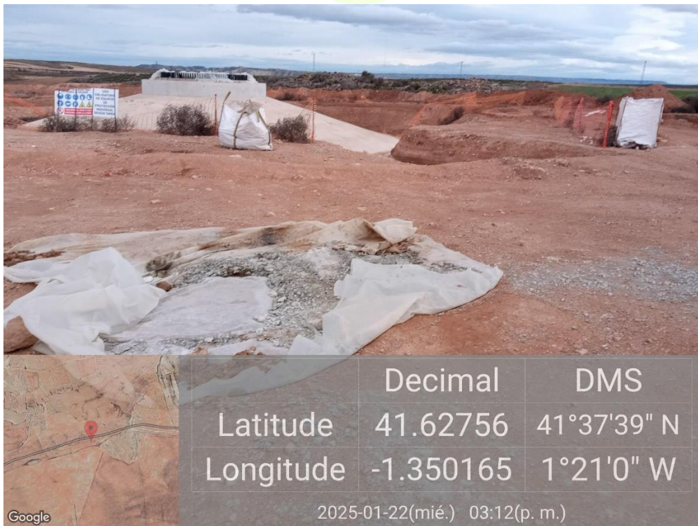
Ilustración 60. Limpiezas de hormigón fuera de la balsa en la plataforma 08.
