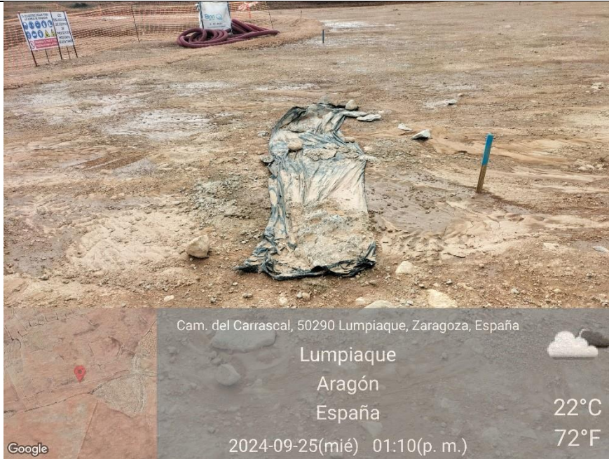
Ilustración 23. Limpieza de hormigón fuera de plástico protector en plataforma 08 de la visita anterior sin recoger.
