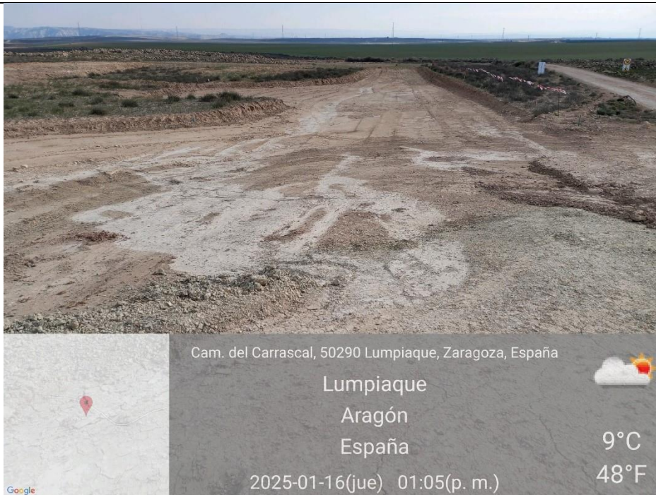
Ilustración 57. Corrección del vertido mal hecho en la plataforma 06.
