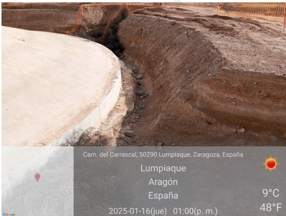
Ilustración 10. Zanja con residuos dispersos.
