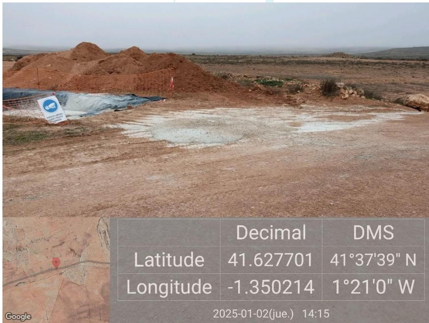
Ilustración 50. Balsa de hormigón llena resultando en un vertido de hormigón en la plataforma 08.
