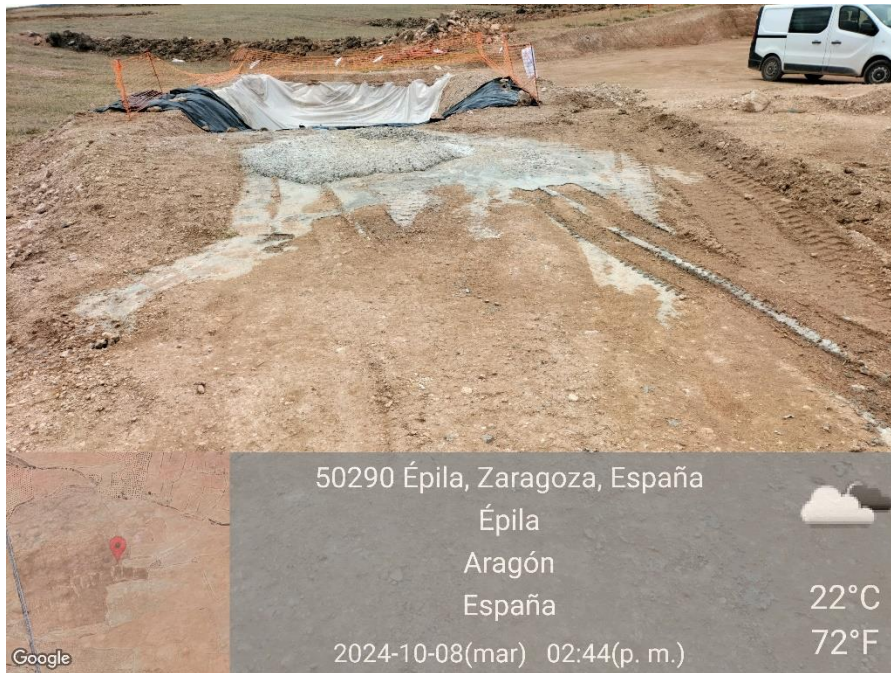
Ilustración 22. Nuevamente limpieza de cuba hecha fuera de la balsa de la plataforma 03.
