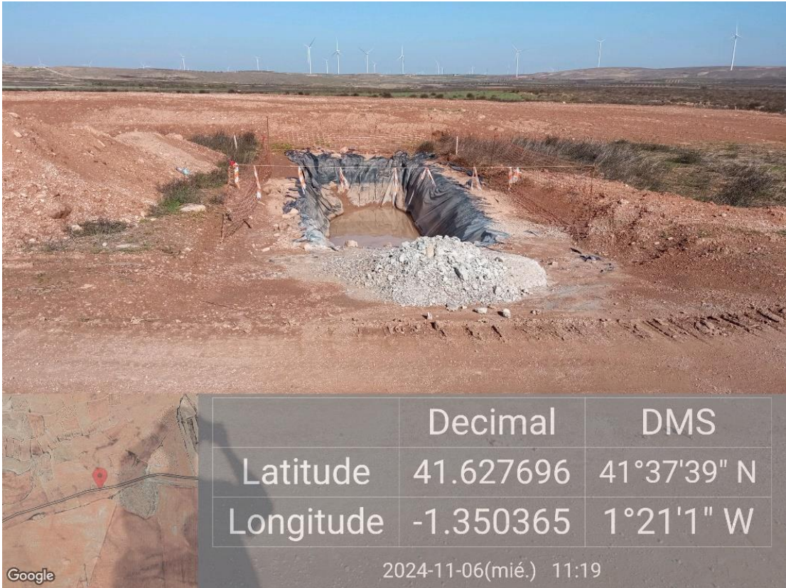
Ilustración 28. Continúa limpieza fuera de balsa sin corregir en la plataforma 08.
