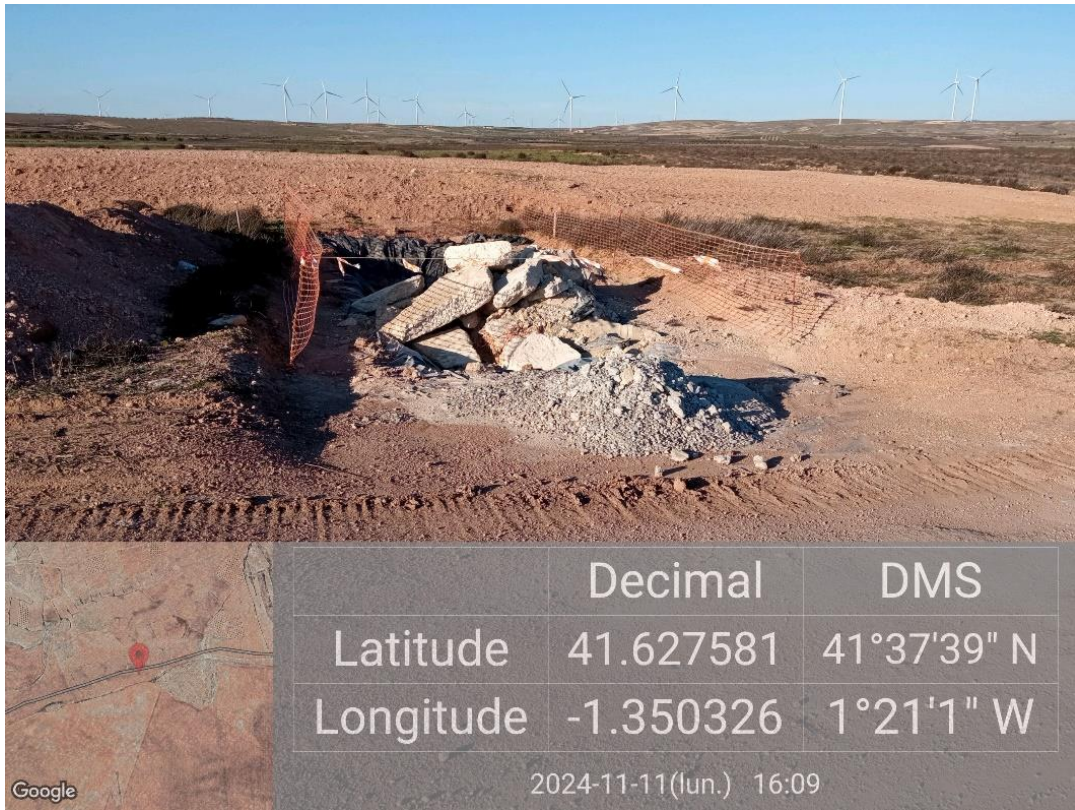
Ilustración 30. Continúa limpieza fuera de balsa sin corregir en la plataforma 08.
