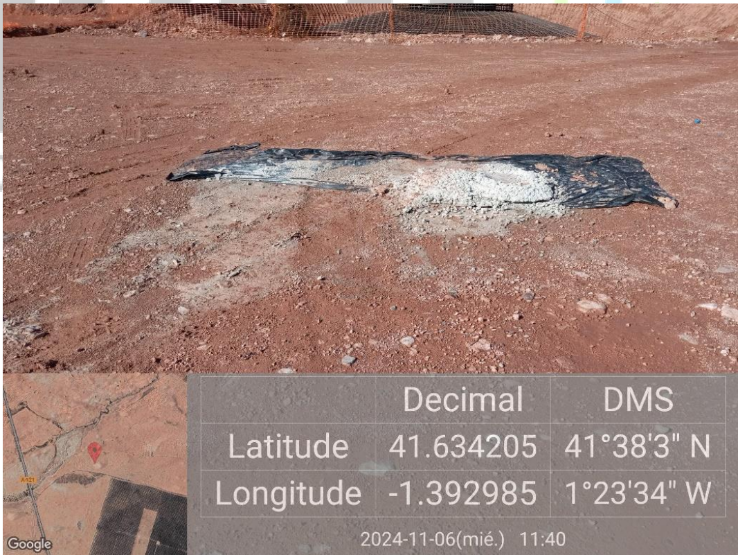
Ilustración 29. Continúa limpieza fuera de plástico aislante sin corregir en la plataforma 01.
