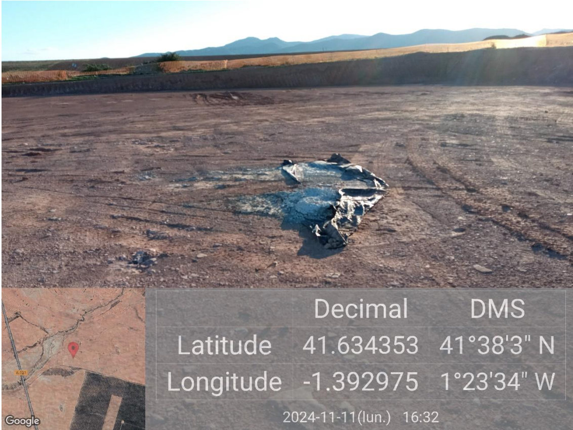
Ilustración 4. Restos de limpieza de hormigón vertidos fuera de un plástico protector en la plataforma 01.
