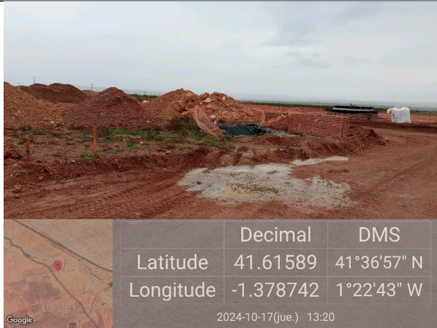
Ilustración 24. Vertido de agua de limpieza de cubas fuera de la balsa de la plataforma 05.
