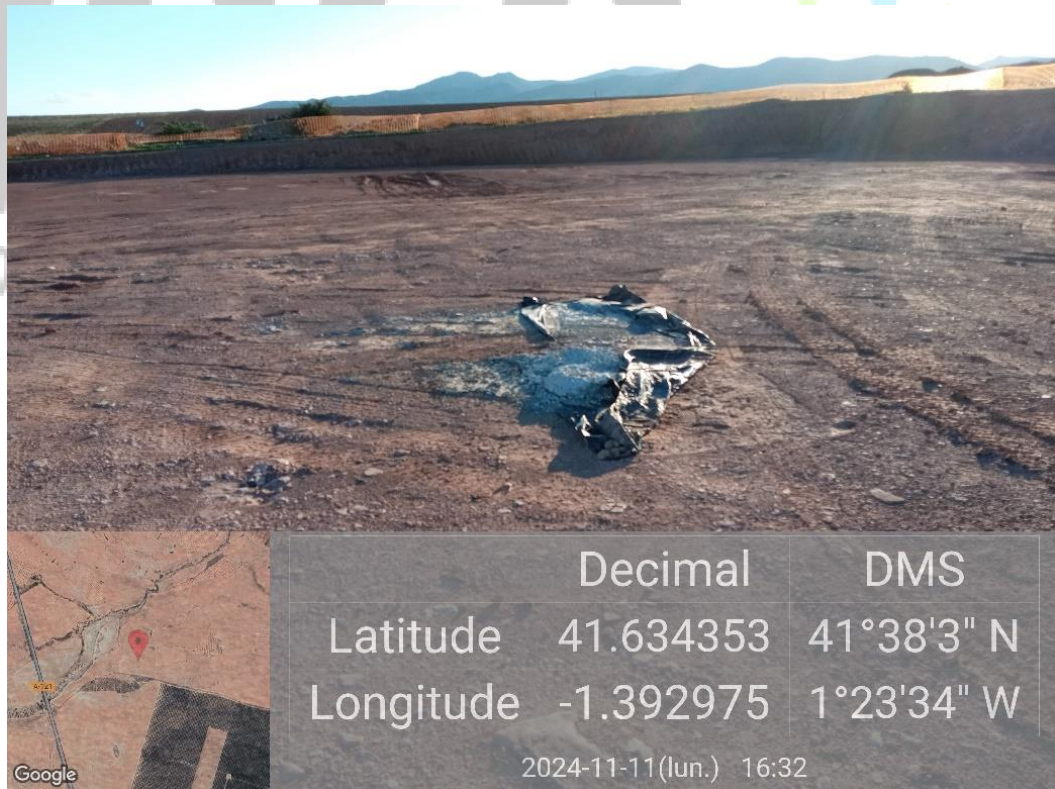
Ilustración 31. Continúa limpieza fuera de plástico aislante sin corregir en la plataforma 01.
