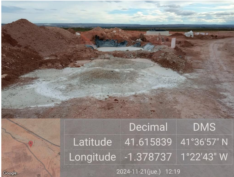
Ilustración 34. Nuevamente limpieza de hormigón hecha fuera de la balsa de la plataforma 05 y anterior sin corregir.
