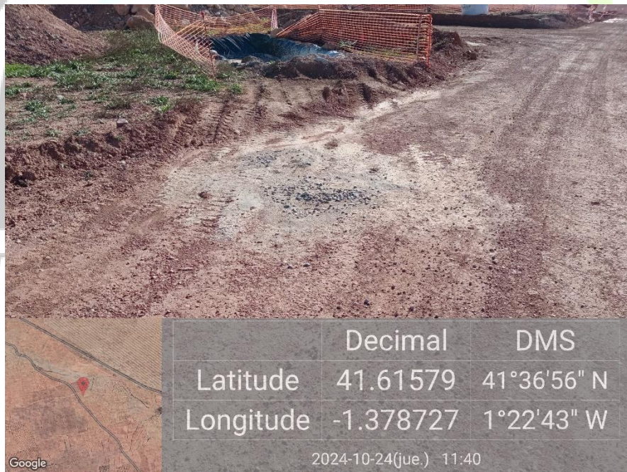
Ilustración 25. Limpieza de hormigón hecha fuera de la balsa en la plataforma 05 todavía sin corregir.
