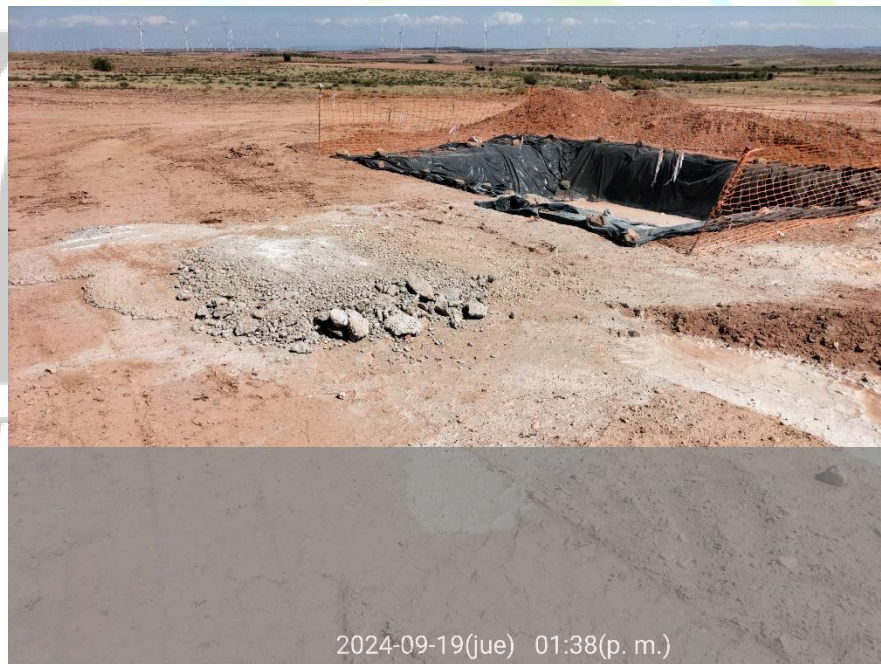
Ilustración 17. Limpieza de cuba de hormigón realizada fuera de la balsa de la plataforma 01.
