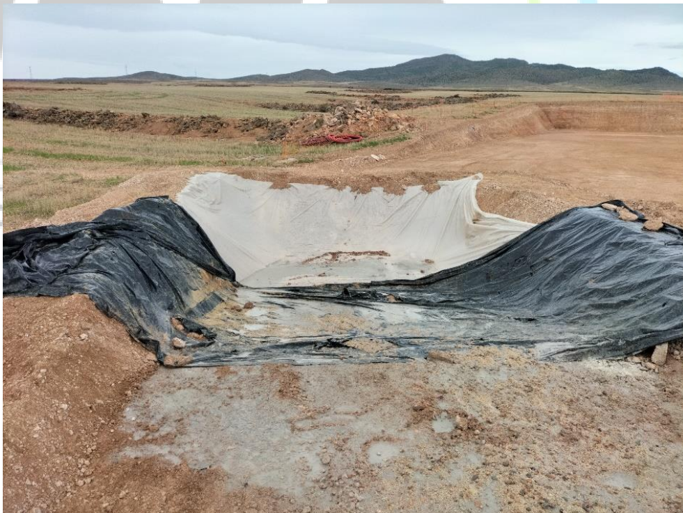
Ilustración 21. Limpieza de cuba de hormigón hecha fuera de la zona aislada de la balsa de la plataforma 03.
