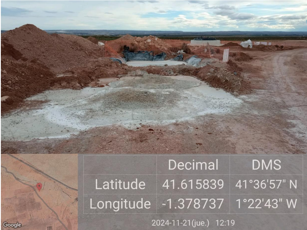
Ilustración 8. Limpieza de cuba de hormigón realizada fuera de la balsa de la plataforma 05.
