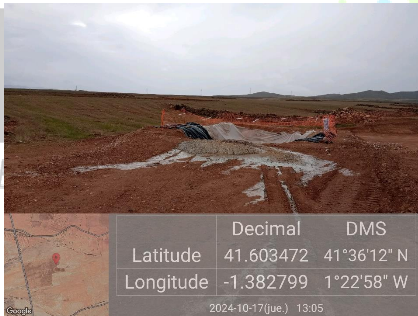
Ilustración 23. Continúa sin gestionar los restos de la limpieza de cuba hecha fuera de la balsa de la plataforma 03 realizada en las visitas anteriores.
