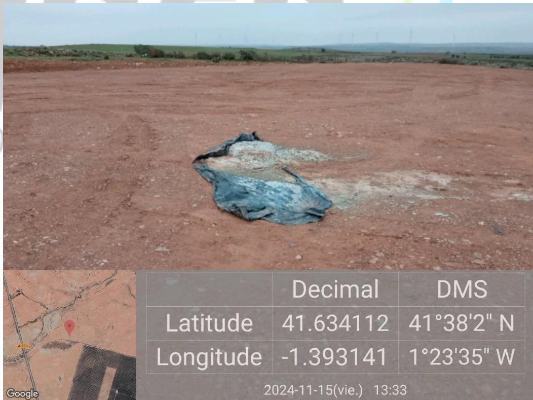
Ilustración 33. Continúa limpieza fuera de plástico aislante sin corregir en la plataforma 01.
