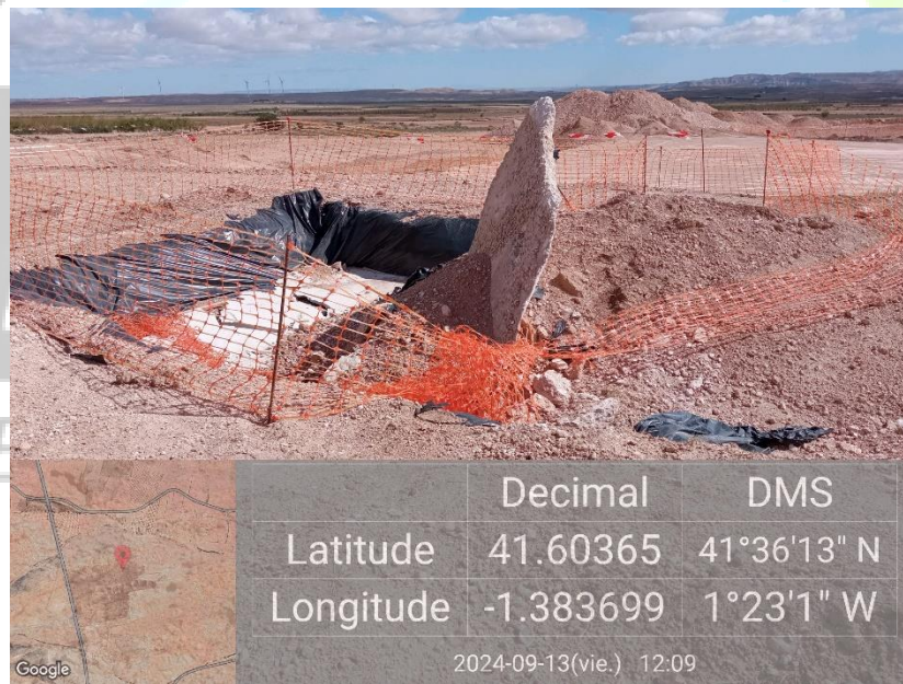
Ilustración 15. Balsa de plataforma 03 en mal estado.
