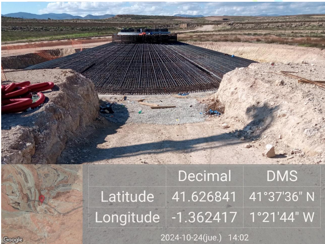
Ilustración 8. Residuos en la zanja de la plataforma 06.
