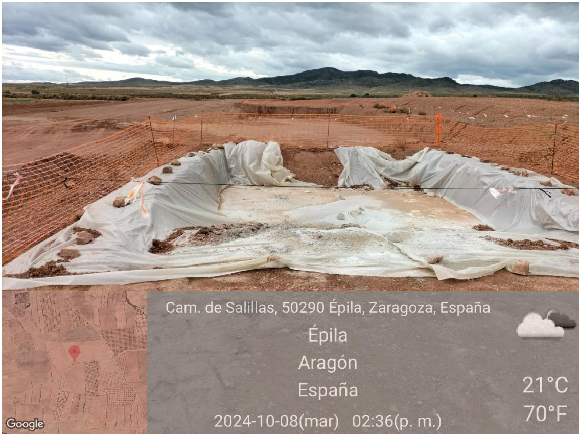
Ilustración 4. Balsa para la limpieza de cubas de hormigón de la plataforma 04.
