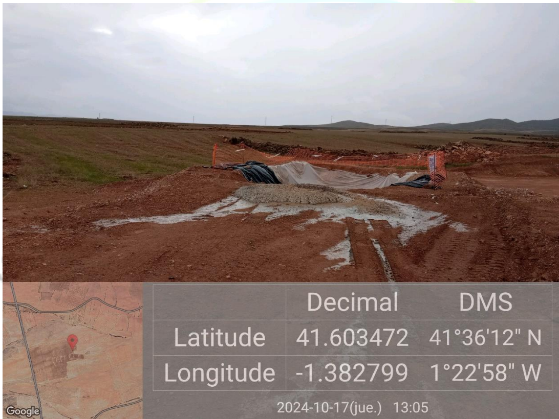
Ilustración 6. Restos de limpieza de hormigón fuera de la balsa para la limpieza en la plataforma 03.
