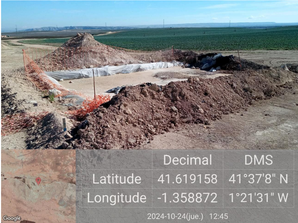
Ilustración 9. Corrección de balsa para la limpieza de hormigón de la plataforma 07.
