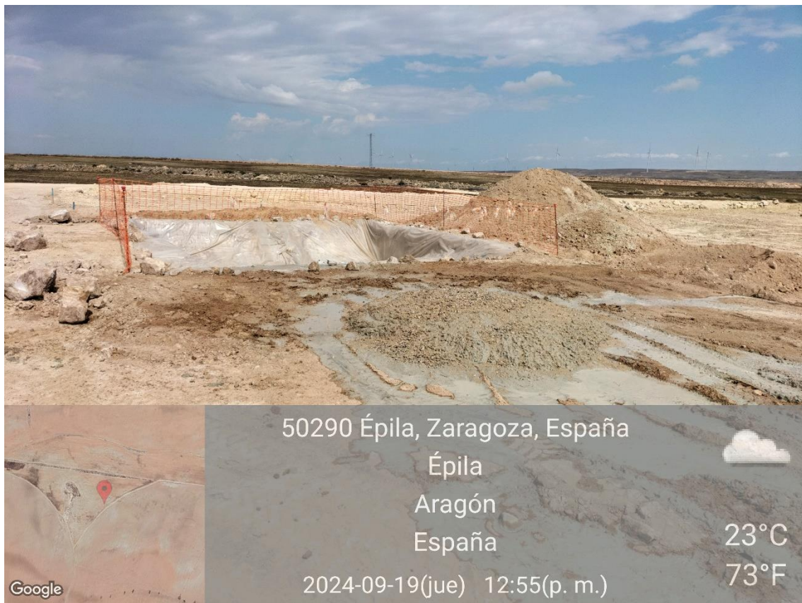
Ilustración 6. Restos de limpieza de hormigón fuera de la balsa para la limpieza en la plataforma 07
