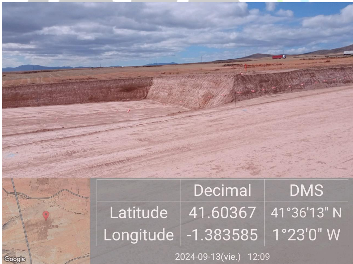
Ilustración 4. Taludes sin erosión en la plataforma 04.
