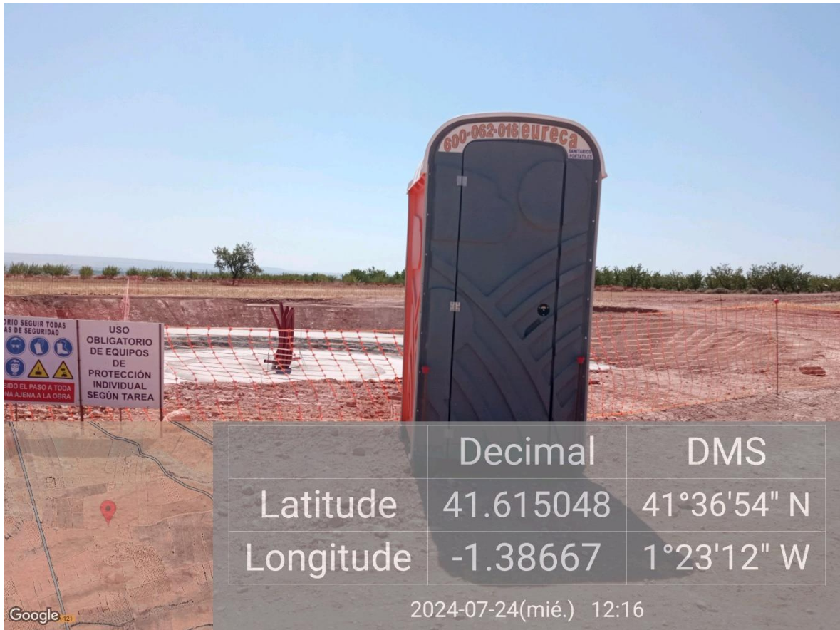
Ilustración 8. Baño químico instalado en la plataforma del aerogenerador 02.
