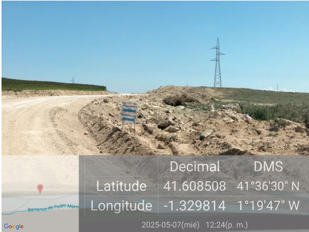
Ilustración 4. Zanja cerrada con sobrantes de excavación durante la visita 43
