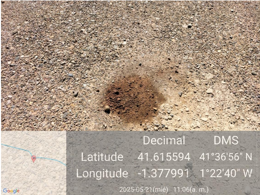
Ilustración 14. Mancha de vertido localizada durante la visita 45.
